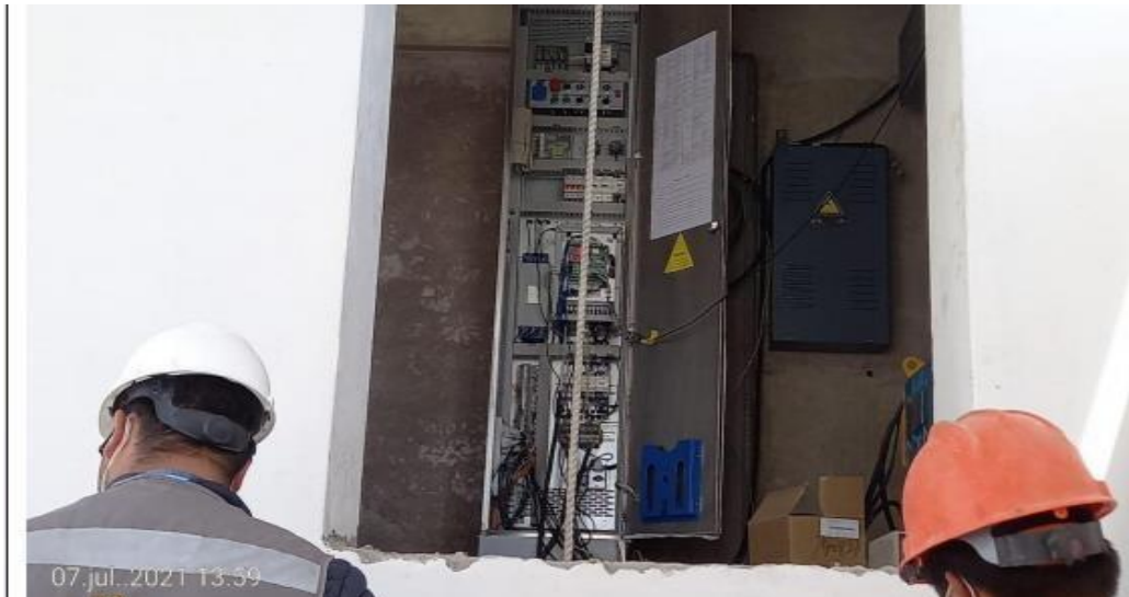
Figura 20: Tableros de control de ascensores.
