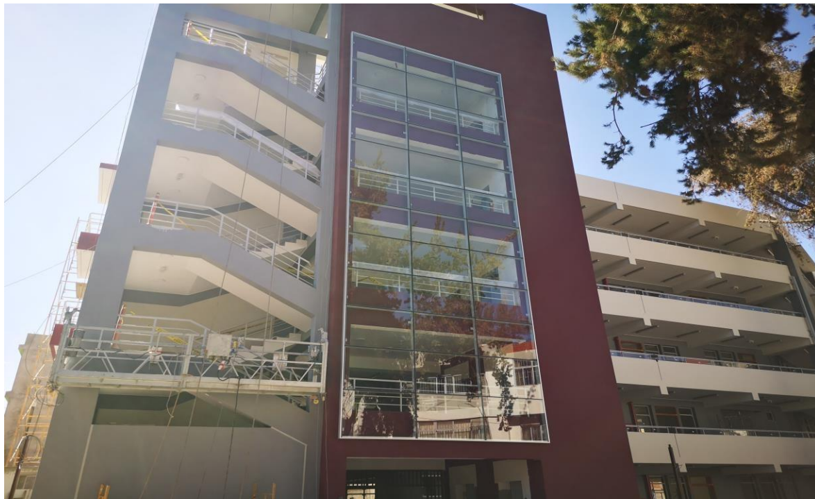
Figura N° 83: Cortina de vidrio en ascensor
