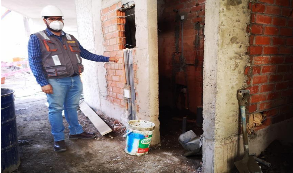
Figura 10: Tuberías para instalaciones eléctricas.
