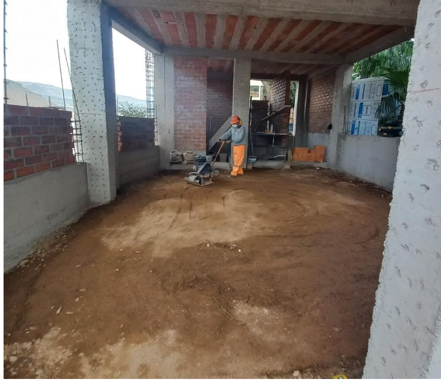
Figura 70. Vista fotográfica de relleno compactado con material de préstamo en el bloque 05.
