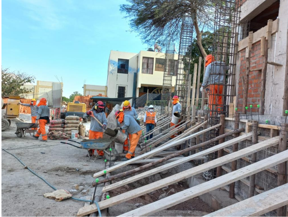
Figura 81. Vista fotográfica de vaciado de concreto en muro de contención de gradería 02 en el bloque 06.
