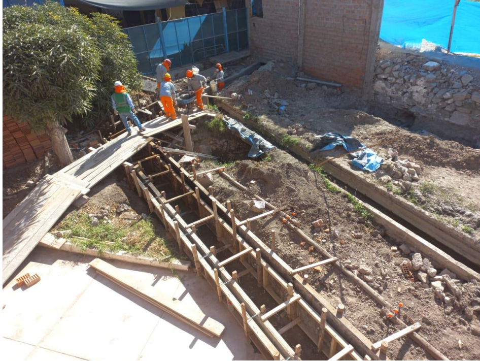
Figura 32. Vista fotográfica de encofrado y vaciado de concreto para canal de regadío provisional en bloque 01.
