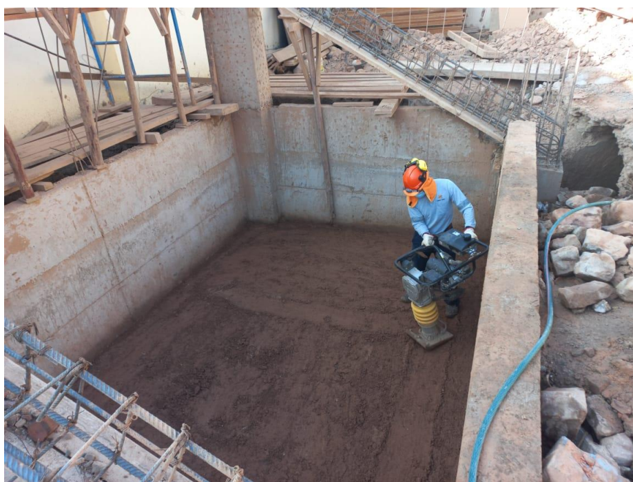
Figura 92. Vista fotográfica de relleno compactado con material de préstamo de gradería 01 tramo II – bloque 06.
