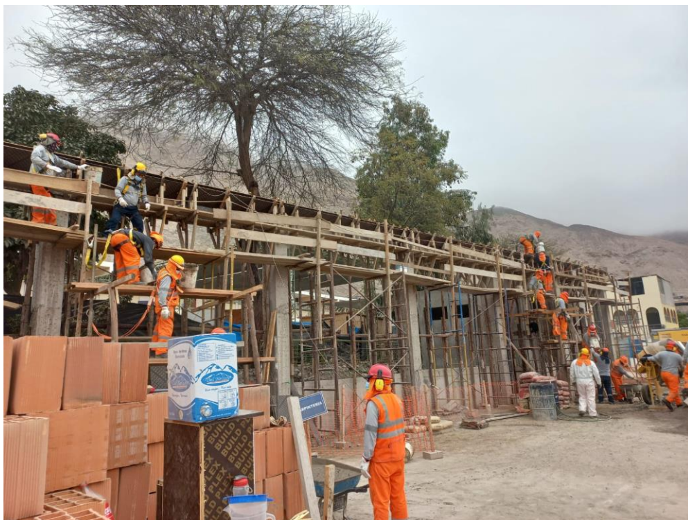
Figura 91. Vista fotográfica de vaciado de concreto en viga principal de cobertura autoportante de gradería 02 tramo I al II – bloque 06.
