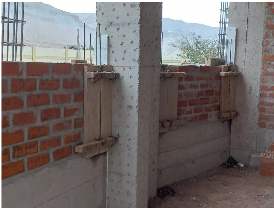
Figura 71. vista fotográfica de encofrado y vaciado de concreto en columnetas en el bloque 05.
