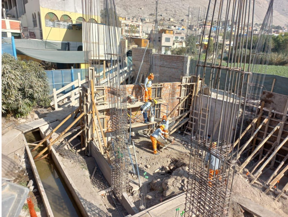
Figura 36. Vista fotográfica de asentado de muros portantes, encofrado y vaciado de concreto F'c=210 \text{ kg/cm}^2 en bloque 01.
