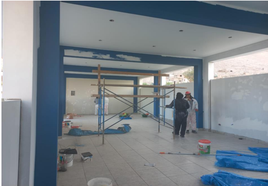
Figura 51. Vista fotográfica de pintura a 02 manos interior del 2do nivel del bloque 01.
