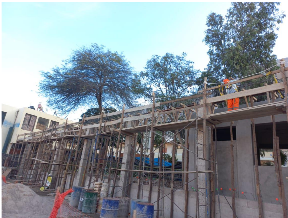
Figura 90. Vista fotográfica de habilitado de acero y encofrado en viga principal de cobertura autoportante de gradería 02 tramo I al II – bloque 06.
