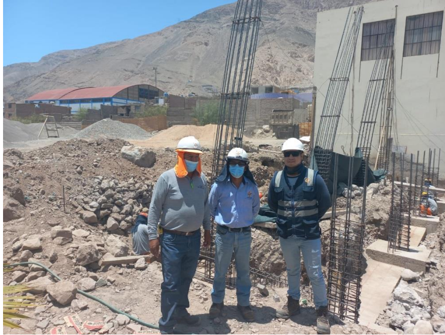
Figura 105. Vista fotográfica de vaciado de zapatas y vigas cimentación en gradería 03 – bloque 06.
