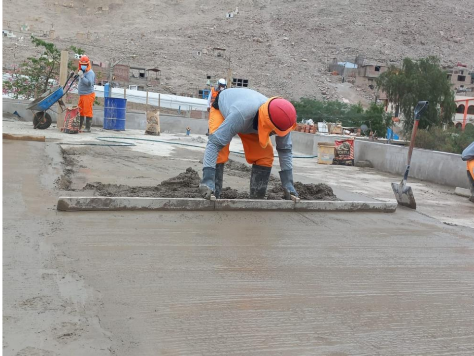
Figura 55. Vista fotográfica de vaciado de entre piso en la azotea en el bloque 04.
