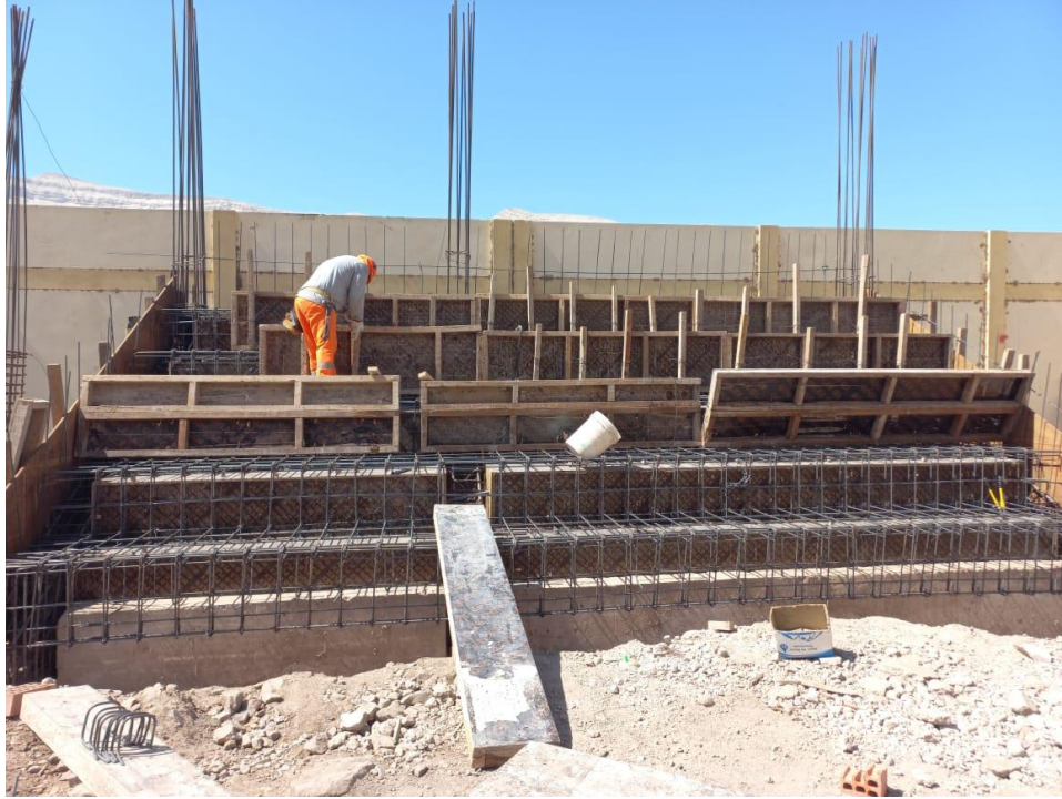
Figura 87. Vista fotográfica de habilitado de acero y encofrado en graderías 01 tramo III – bloque 06.
