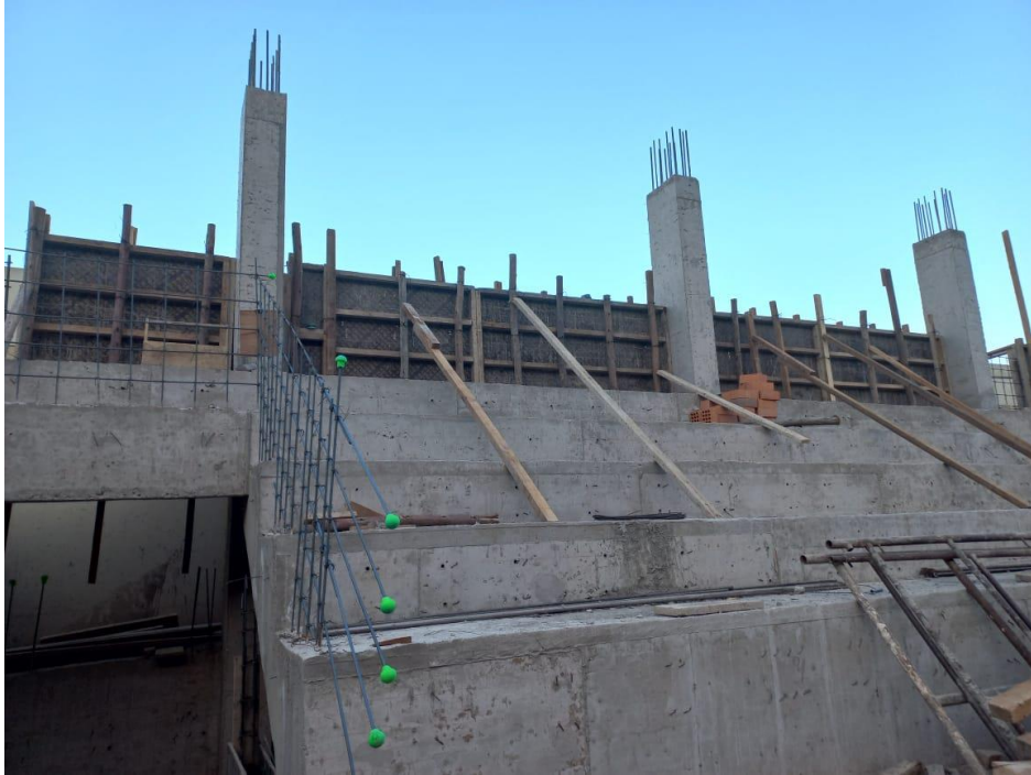
Figura 97. Vista fotográfica de encofrado y vaciado de concreto en parapetos de gradería 01 tramo II – bloque 06.
