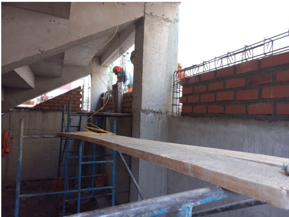
Figura 94. Vista fotográfica de asentado de ladrillo, encofrado y vaciado de concreto en columnetas de gradería 01 tramo III – bloque 06.
