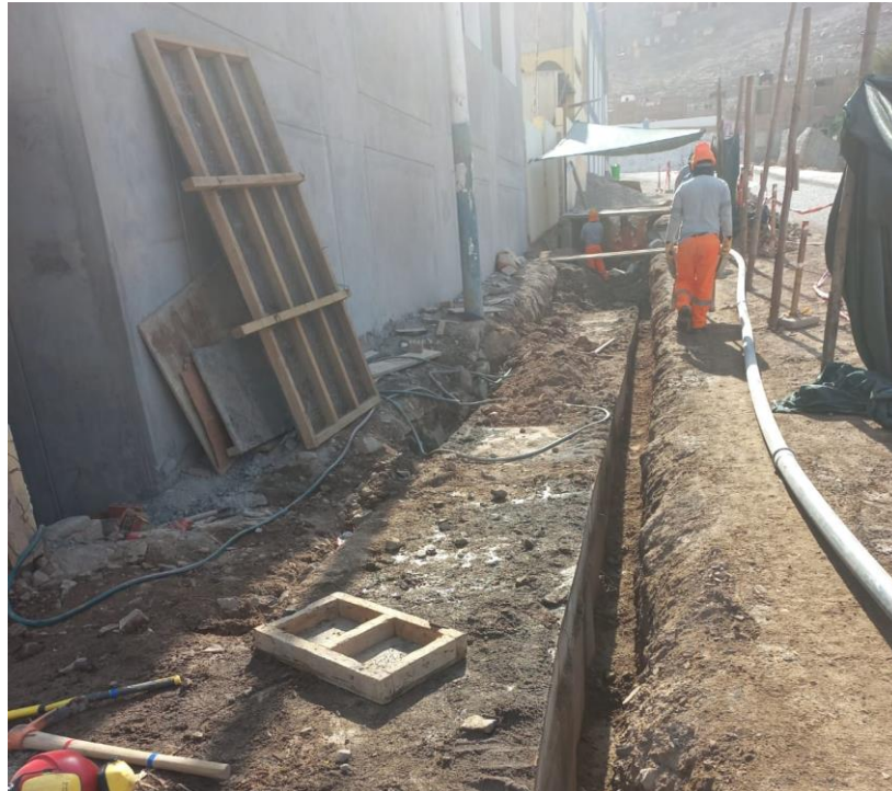
Figura 111. Vista fotográfica de vaciado de concreto f'c 210 kg/cm 2 en canal de regadío de concreto cerrado en obras exteriores.
