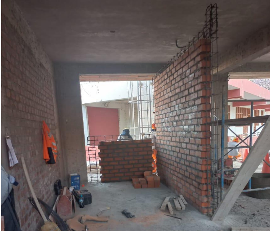
Figura 44. Vista fotográfica de asentado de ladrillo en muros de tabiquería en bloque 01.
