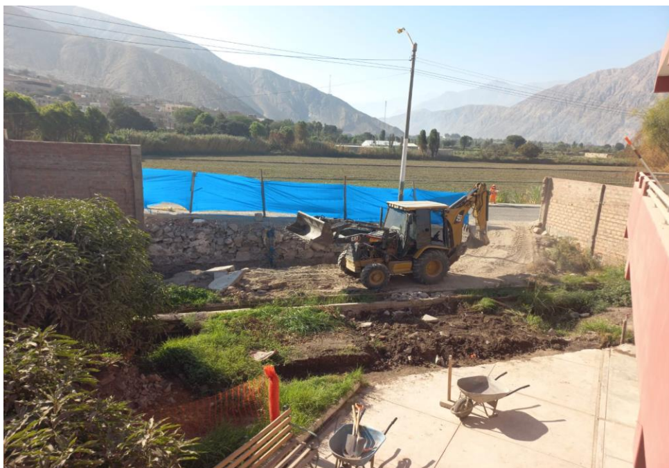
Figura 31. Vista fotográfica de movimiento de tierras y excavación para canal de regadío provisional en bloque 01.
