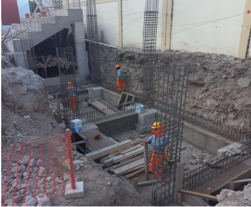
Figura 85. Vista fotográfica de habilitado de acero de vigas de cimentación en gradería 01 tramoII – bloque 06.
