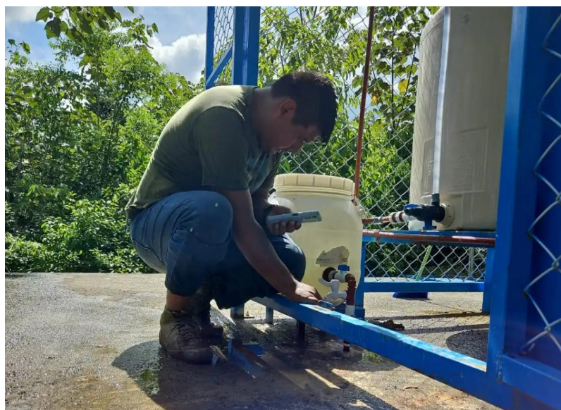
Figura 16. Calibración de sistemas de cloración
