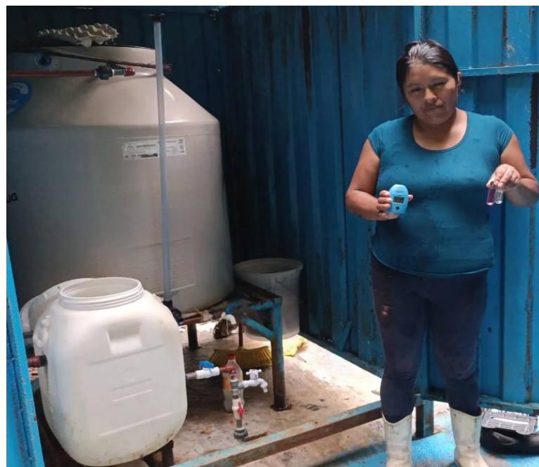
Figura 15. Monitoreo de cloro residual en tanque de almacenamiento
