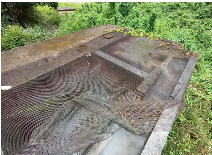
Figura 10. Filtro de agua del sistema de abastecimiento
