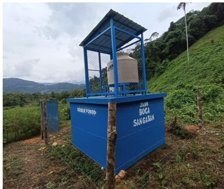
Figura 18. Sistema de captación de agua post mantenimiento
