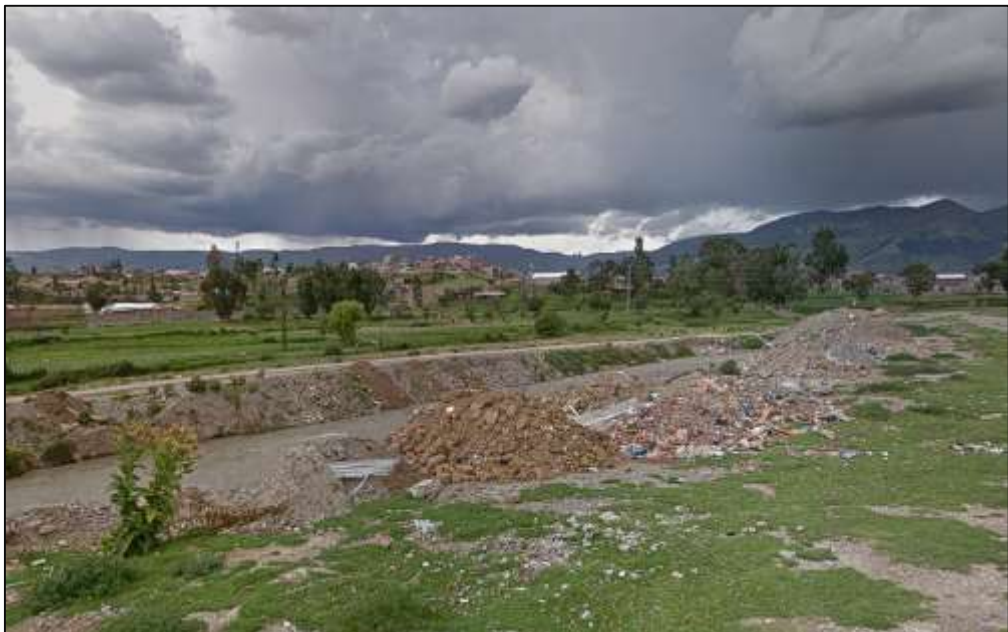
Desmonte y Residuos sólidos cerca al Rio Shullcas
