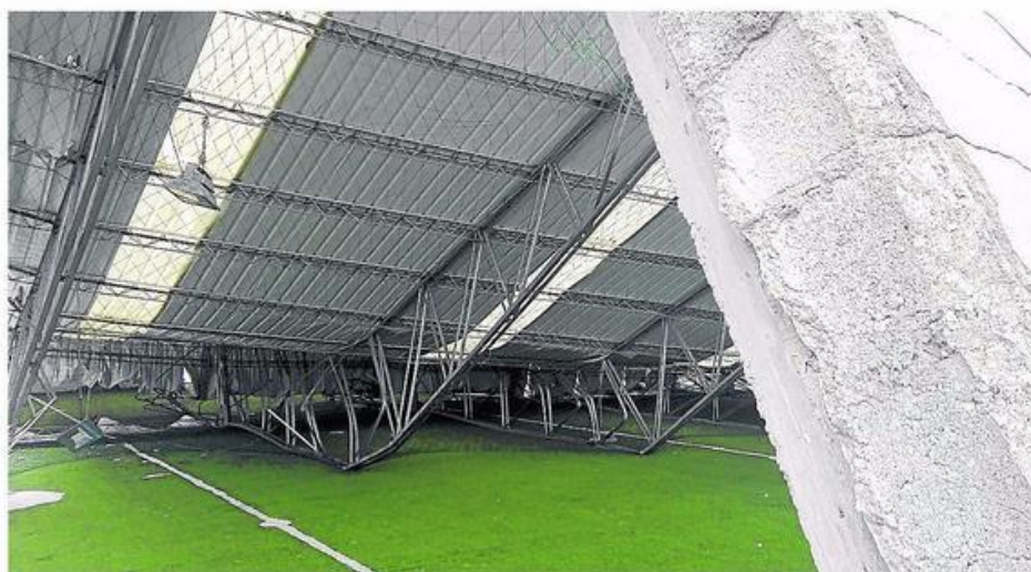
Figura 3. Colapso de cobertura en grass sintético. Fuente: Noticias Pasco (Diario Correo, 2017)
