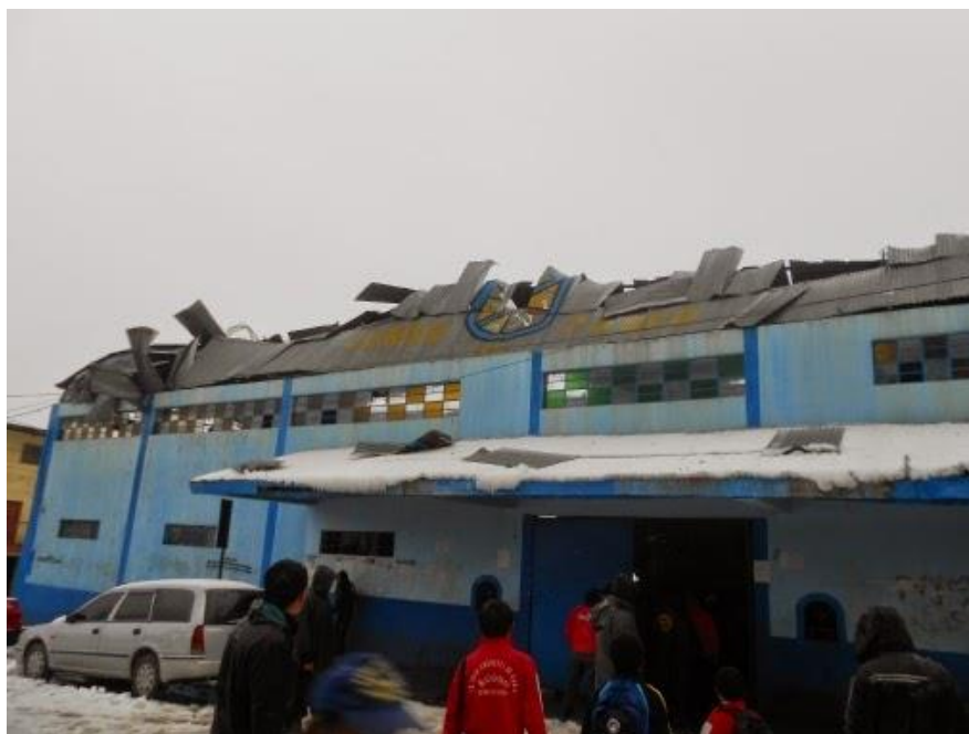
Figura 4. Colapso del techo del Coliseo Municipal Pasco. Fuente: Noticias Pasco (Andina Noticias, 2012)
