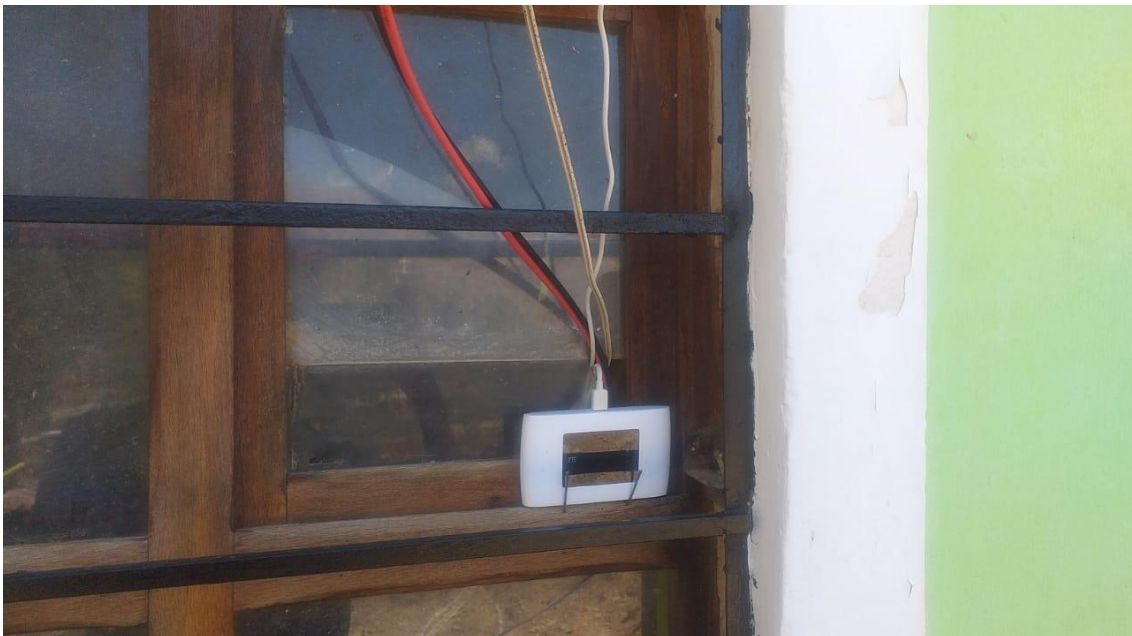
Figura 68. Instalación del Modem ZTE MF920U. Tomado por el autor.
