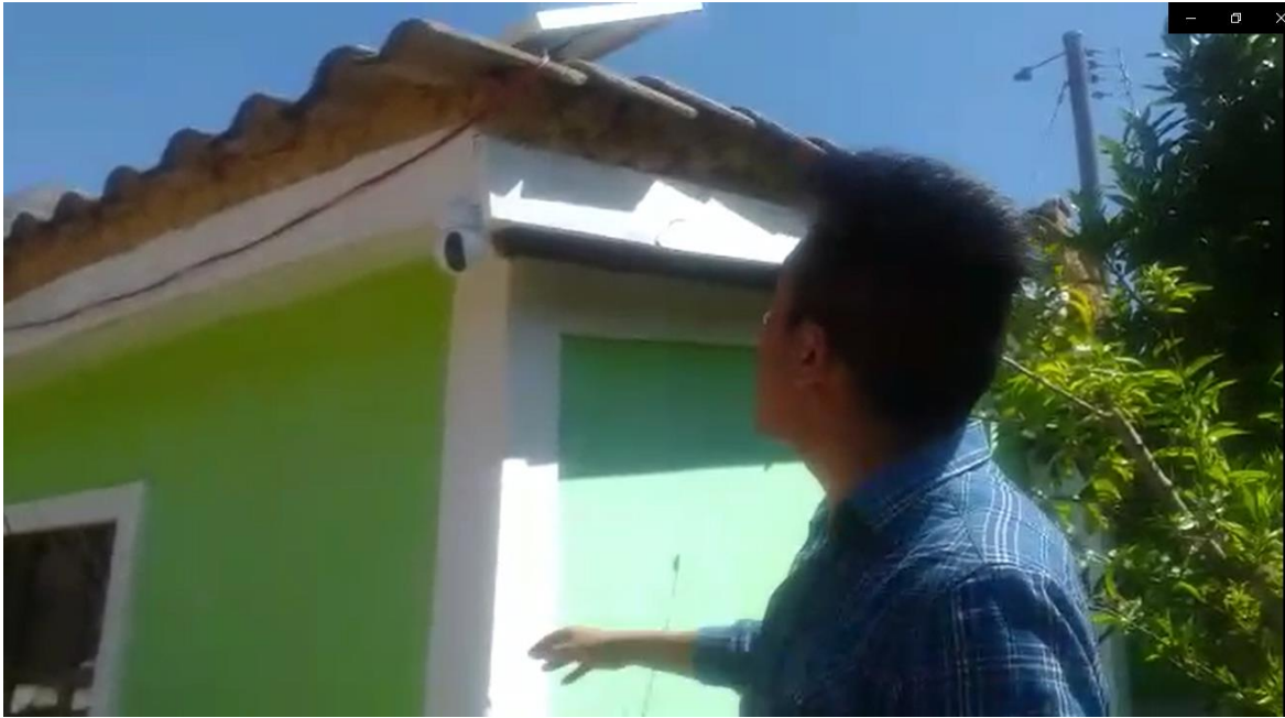
Figura 82. Verificación de la cámara 2. Tomado por el autor.
