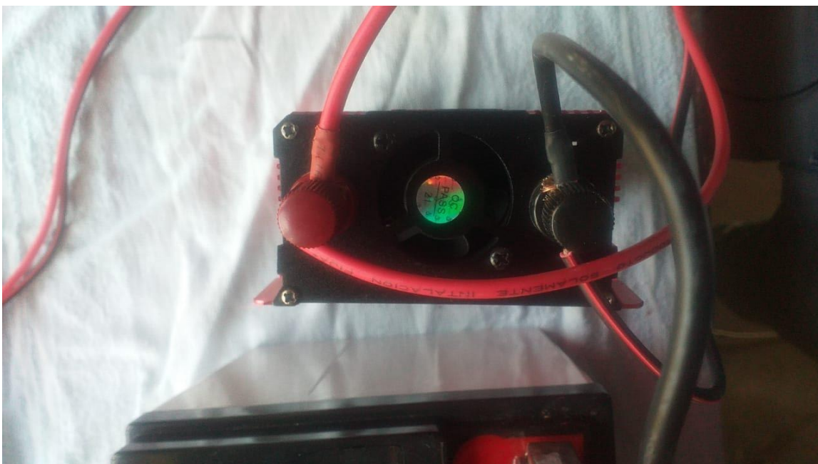
Figura 61. Instalación del Controlador Solar y el Inversor KC-1000D. Tomado por el autor.
