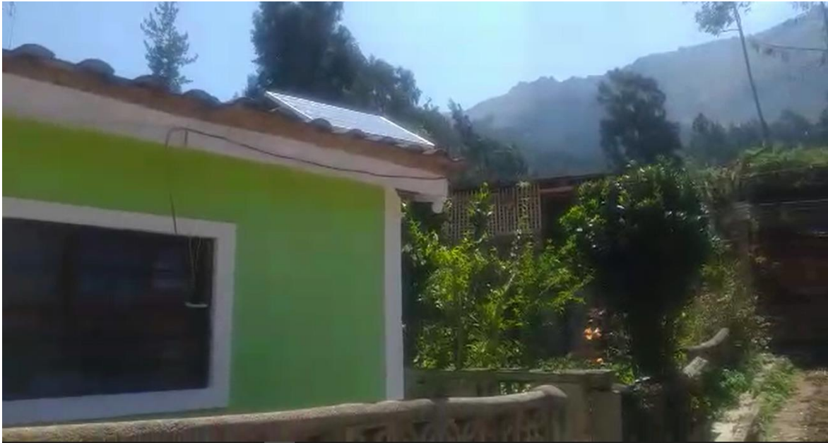
Figura 80. Prueba de la conexión de la batería, el conversor, el modem y el panel solar. Tomado por el autor
