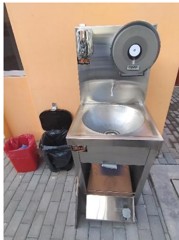
Ilustración 64 Lavatorio ubicado a la salida de vacunatorio
