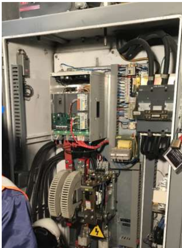
Montaje de tablero en Perforadora
