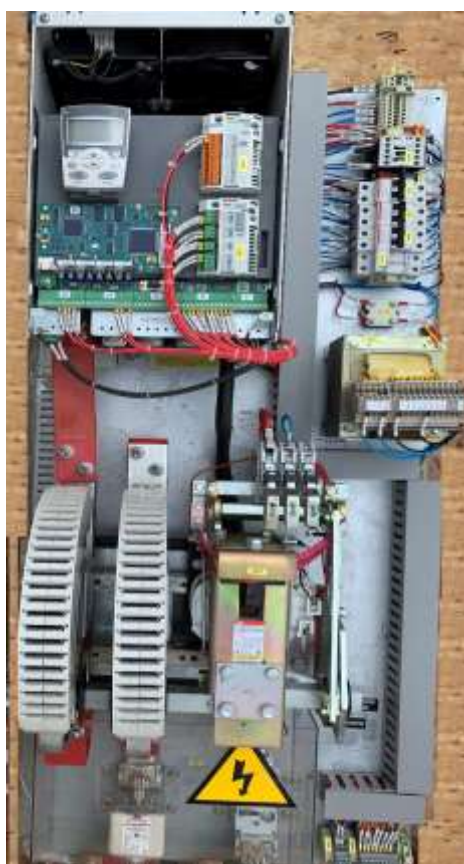
Variador DCS800 armado en tablero con componentes eléctricos
