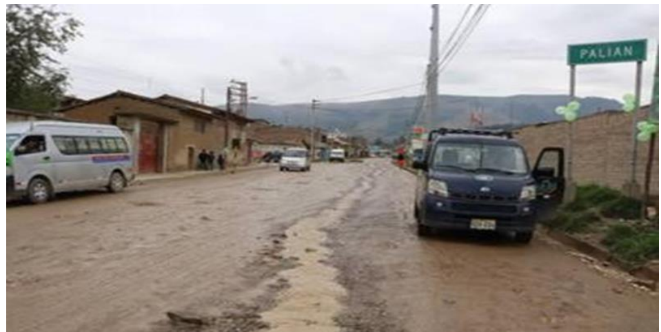
Figura 2. La avenida Palian en la provincia de Huancayo sin pavimentar
