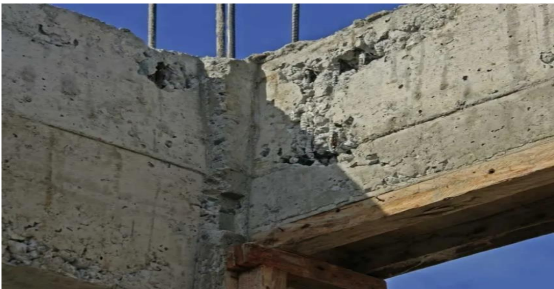
Figura 4. Segregación es la separación de los ingredientes de la mezcla de hormigón. Tomado de https://arqmorales009.wixsite.com/inaconstruccion/post/recomendaciones-para-realizar-un-vaciado-de-concreto
