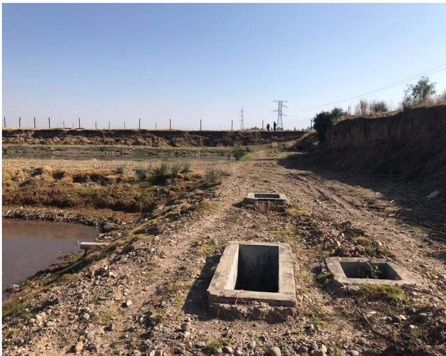
Fotografía 12. Estado actual de las lagunas de oxidación de la PTAR existente en el Centro Poblado de Huamanmarca.
