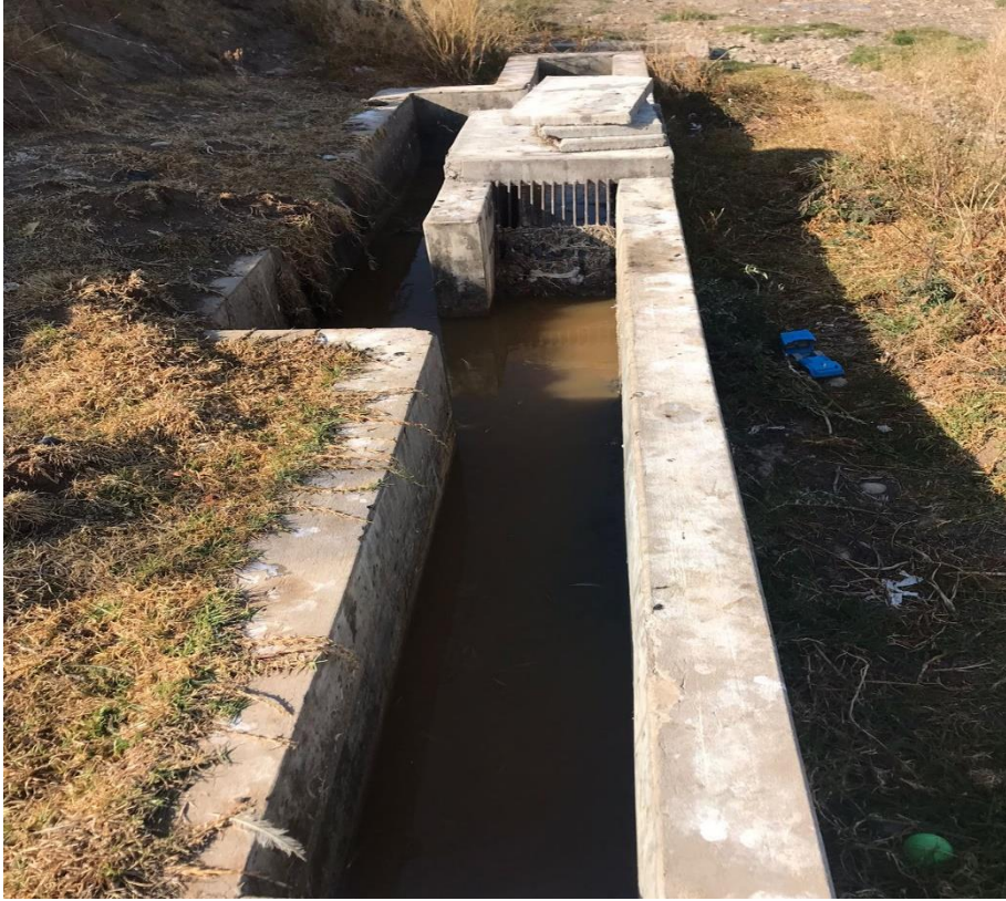
Fotografía 11. Estado actual del pretratamiento de la PTAR existente en el Centro Poblado de Huamanmarca.
