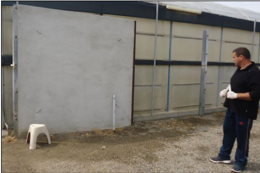
Figura 62. Estructura del muro final específicamente diseñado y construido que sostendrá la cubierta vegetal del prototipo
