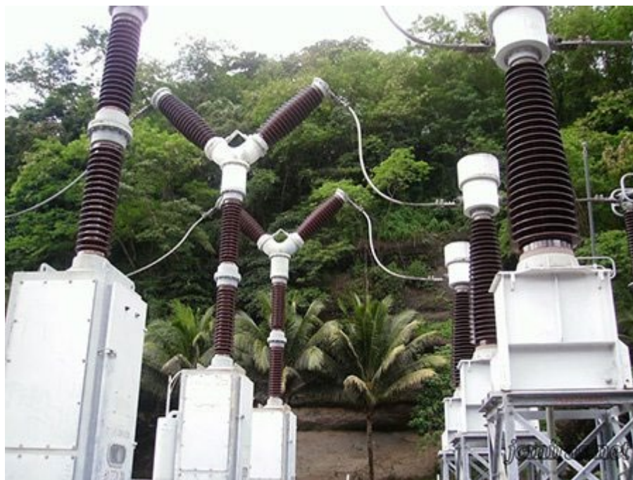
Figura 7.2 Disyuntores SF 6 en un patio de interruptores de alto voltaje
