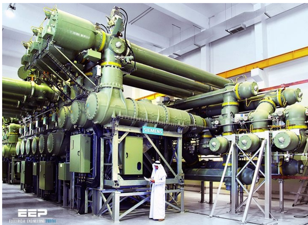
Figura 7.1 Aislamiento en equipos de alta tensión de uso interior
