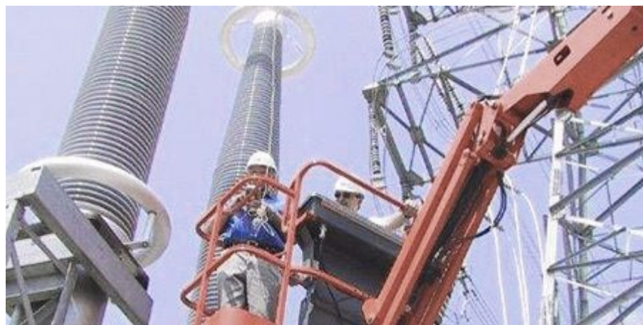
Figura 7.1 Equipos eléctricos de alta tensión que utilizan aire como aislante natural.
