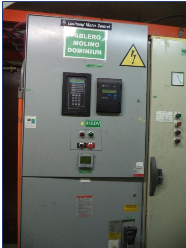
Imagen 19. Tablero de control motor molino Dominion
