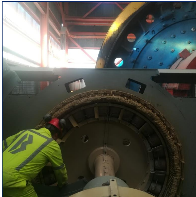
Imagen 18. Vista frontal del motor molino Dominion
