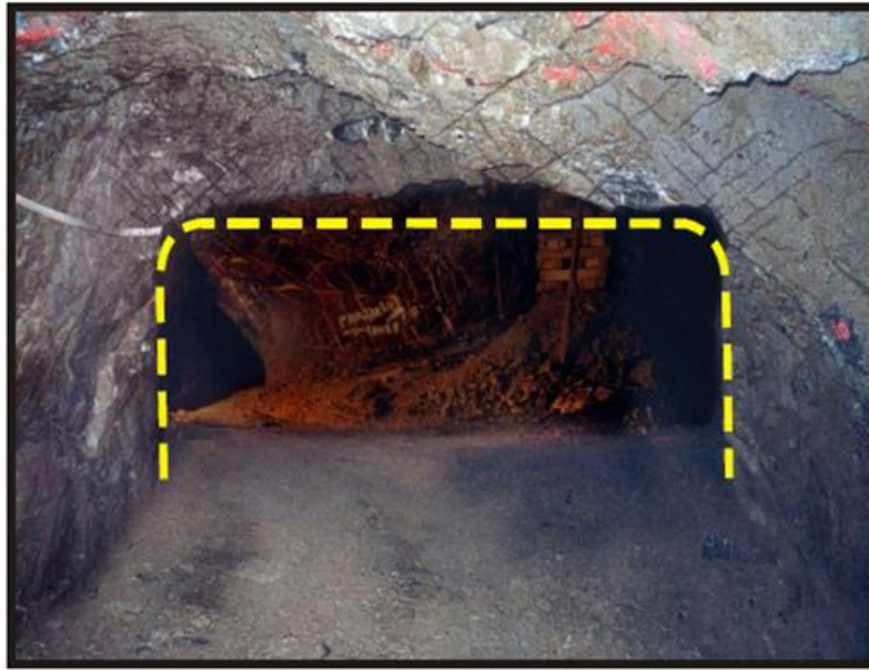
Figura 35. Excavación con geometría desfavorable Tomado de SNMPE, 2004
