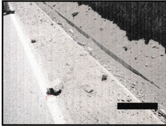
Fig. 3: Situación Inicial de las cunetas y bermas
