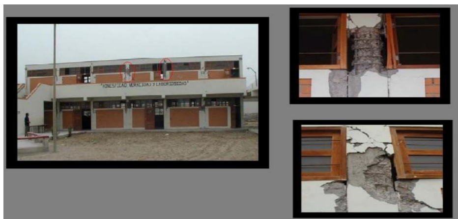
Figura 2. Colegio afectado por el terremoto en Nazca -1996 Tomada de Córdova,2011 (4)
