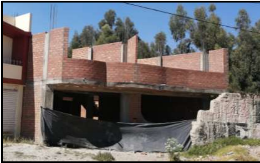
Figura 6: Vivienda con alfézares no aislados de la estructura
