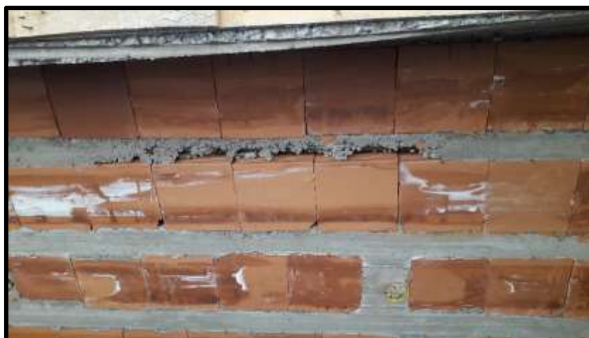
Figura 8: Cangrejas en vigueta de losa aligerada a falta de vibrado.
