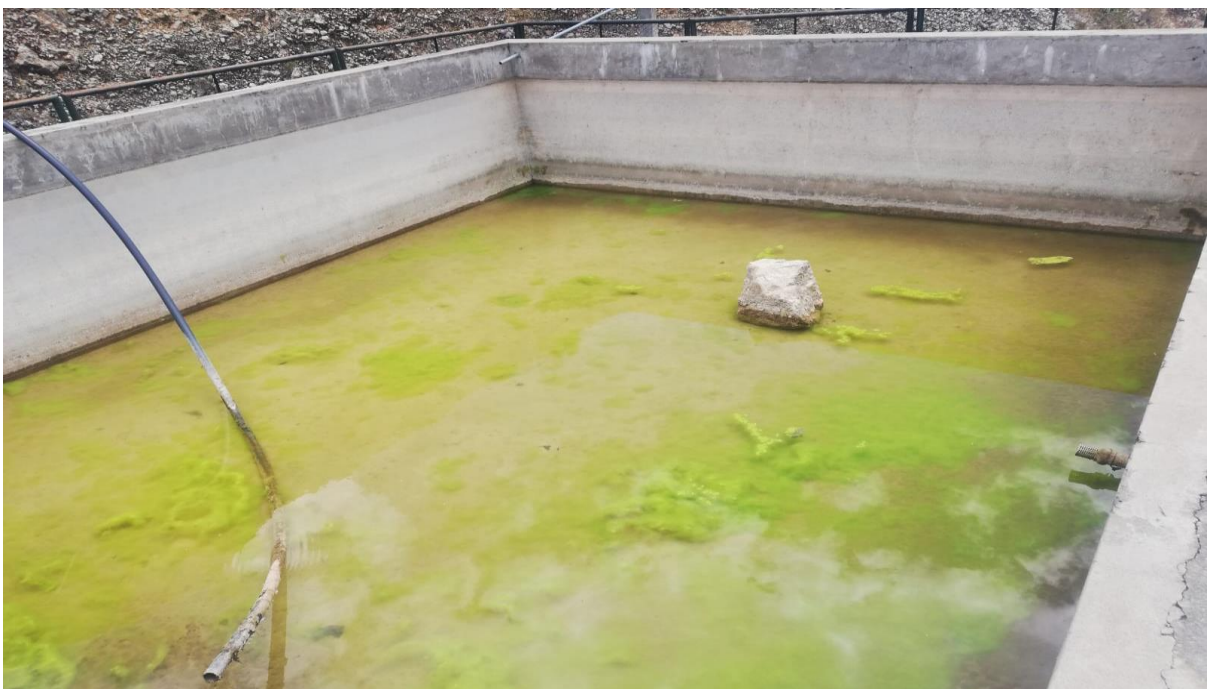
Fotografía 4. Vista del mal estado del repositorio de riego del CC.PP Matahuasi.
