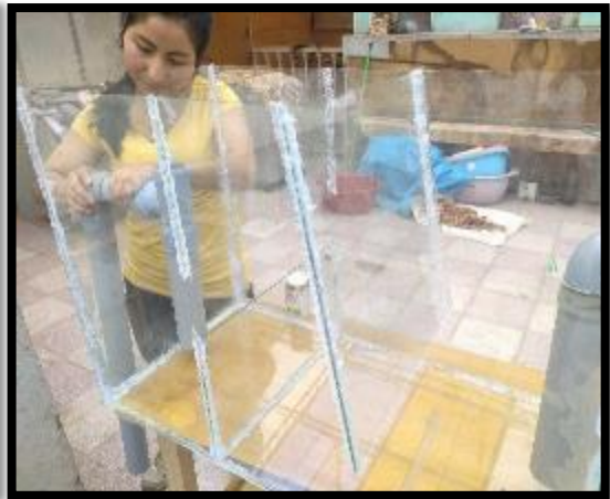
Unión de tubos PVC de 2 plg. a la entrada y salida.
