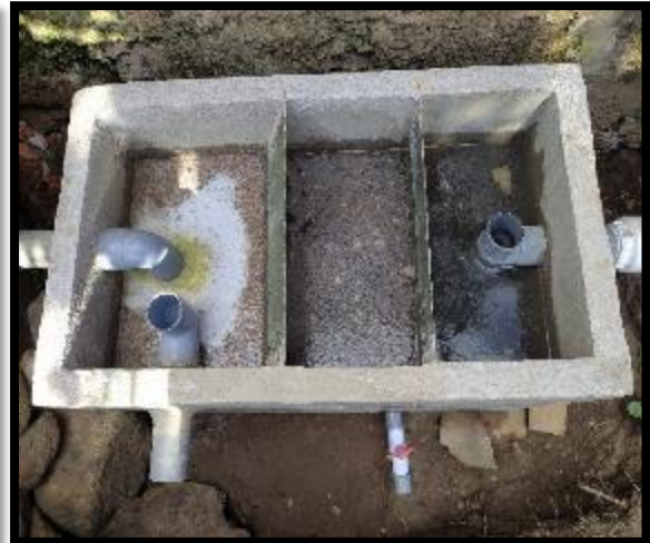
Se aprecia la retencion de grasas y aceites.
