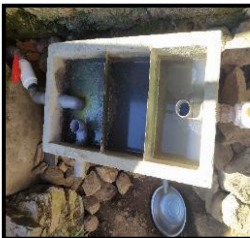
Paso de agua residual en la T.G.
