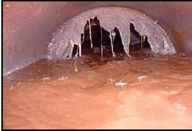
Figura 1. Acumulación de grasa en redes de alcantarillado.
