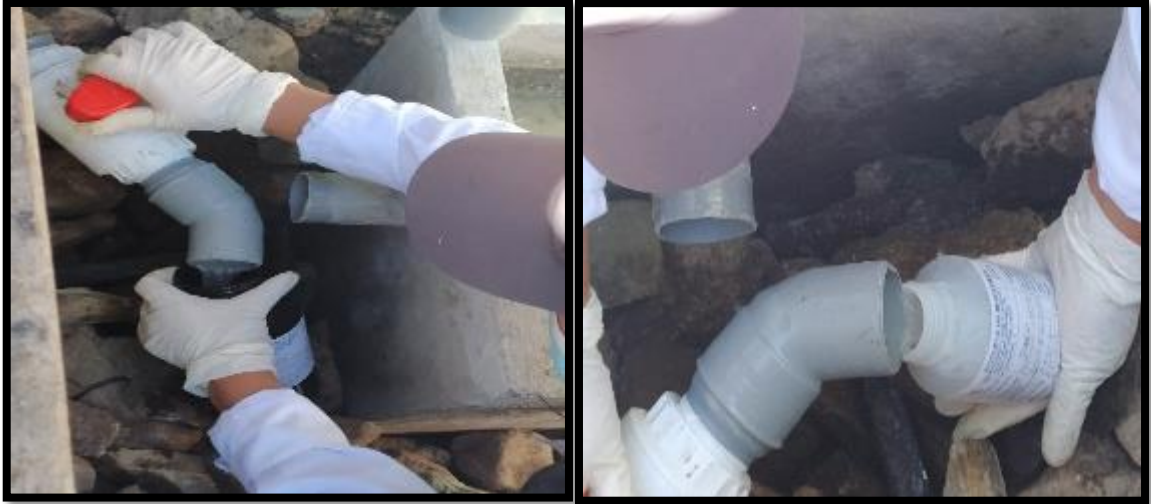
Toma de muestra del del agua residual afluyente a la trampa de grasa.
