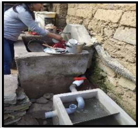
Ingreso de agua residual en la TG.
