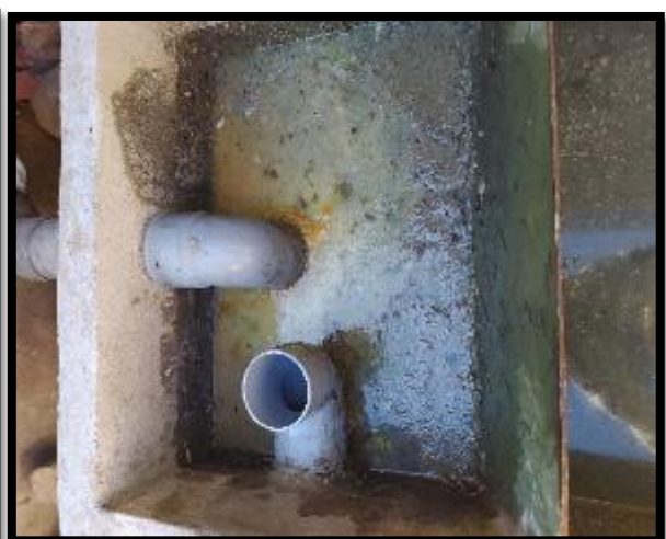
Se aprecia la retencion de grasas en la primera camara.
