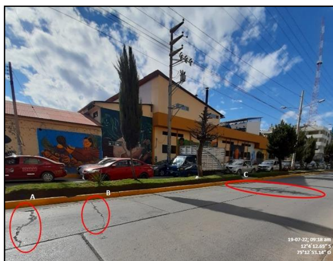
Figura 2: Fallas en el pavimento rígido – HUANCAYO Fuente: Elaboración propia
