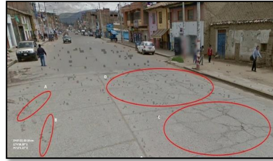
Figura 4: Fallas en el pavimento rígido – CHILCA Fuente: Google Earth
