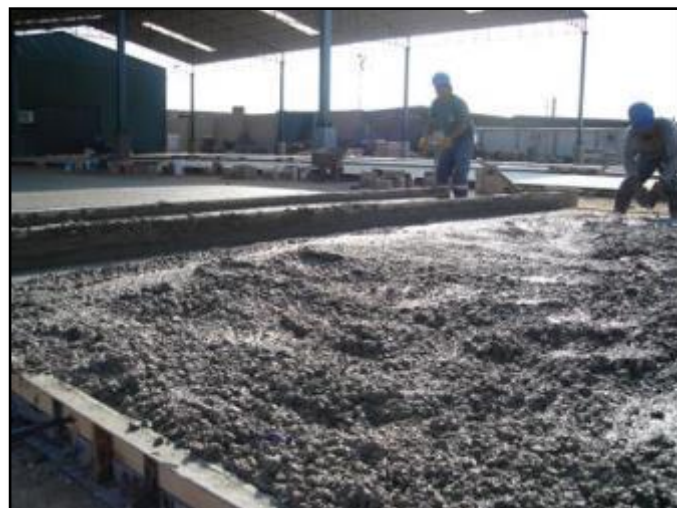
Figura 12: Losa de Almacén Ransa – Lima. Tomado de Macaferri (22)
