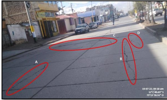
Figura 3: Fallas en el pavimento rígido – EL TAMBO Fuente: Elaboración propia
