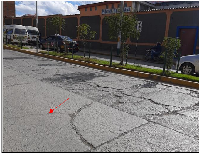
Figura 18: Ejemplo de agrietamiento – HUANCAYO. Fuente: Elaboración propia
