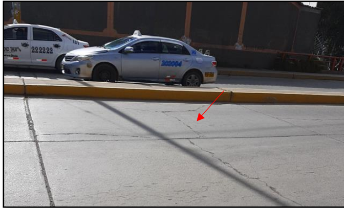
Figura 19: Ejemplo de fisuración– HUANCAYO. Fuente: Elaboración propia
