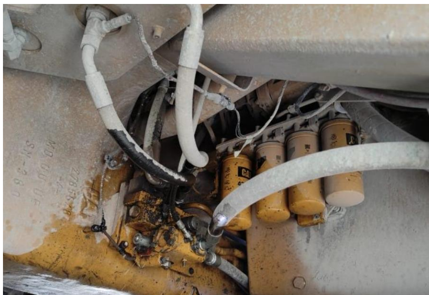
Figura 18: Fuga de combustible por base de filtro terciario
