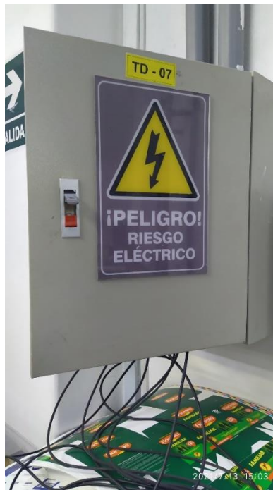
Ilustración 42: Vista de tablero TD-07
