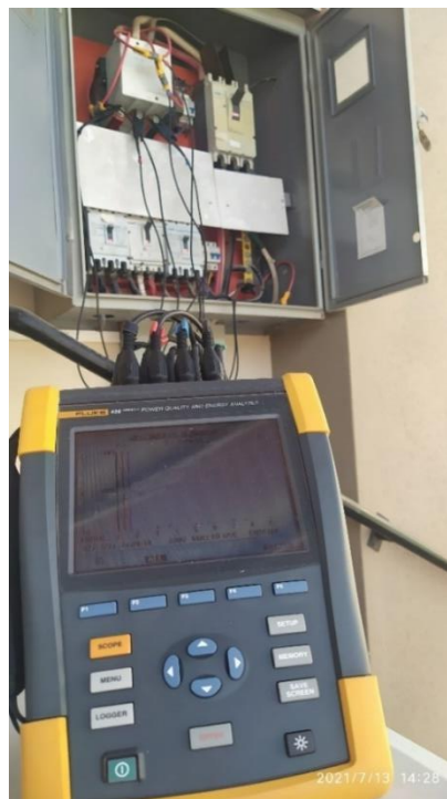
Ilustración 37: Vista de monitoreo tablero TD-01
