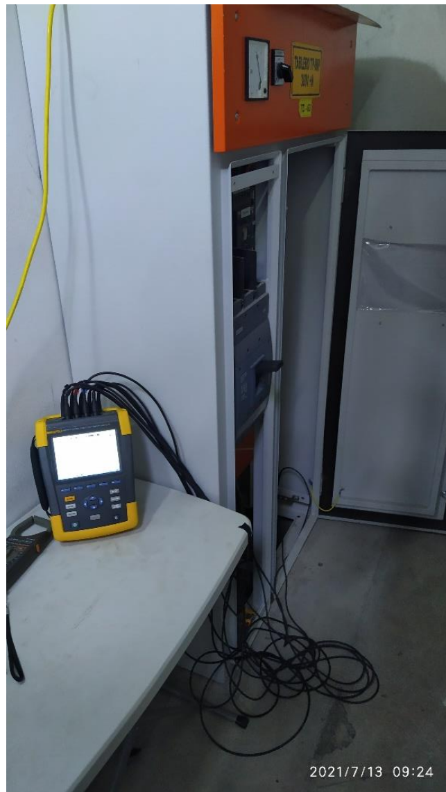
Ilustración 32: Vista del monitoreo de tablero TD-03
