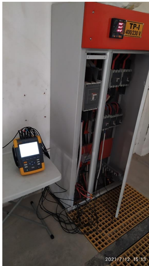
Ilustración 27: Vista de monitoreo del tablero TP-I
