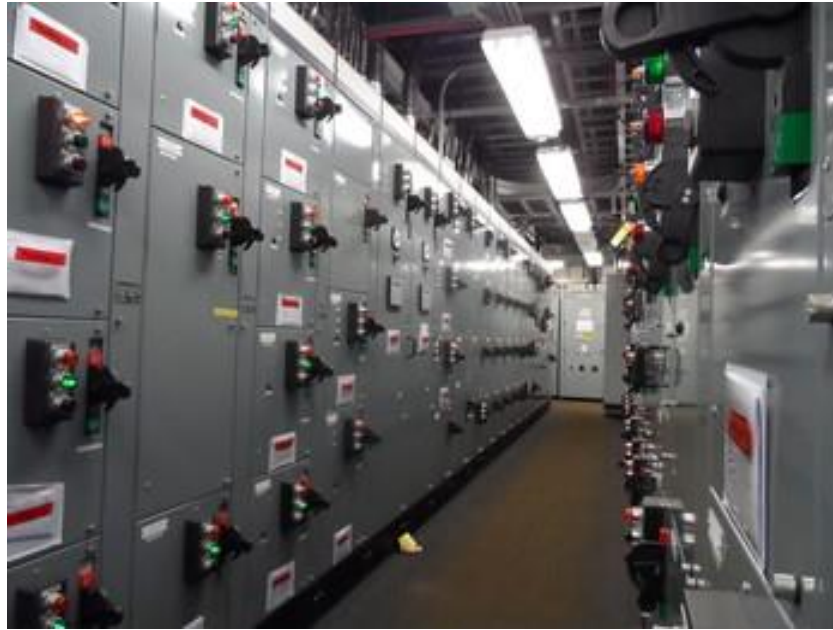
Ilustración 3: Sala Eléctrica Cliente
