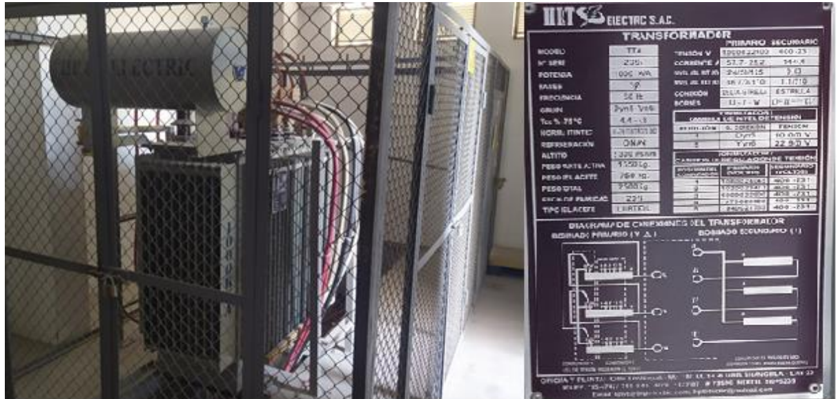
Ilustración 18: Transformador de distribución 1MVA
