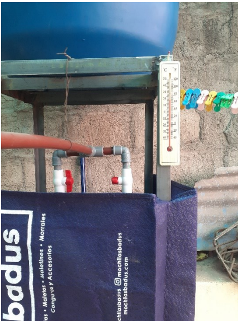
Fotografía N° 15. Control de temperatura diurna y nocturna.
