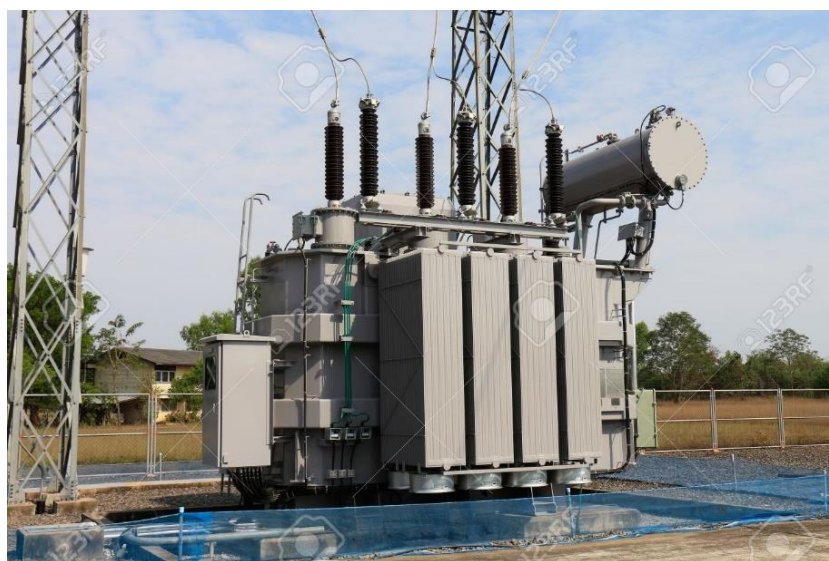
Figura 11. Transformador de potencia. Tomada de “Transformadores de potencia”, Cctrafo.
