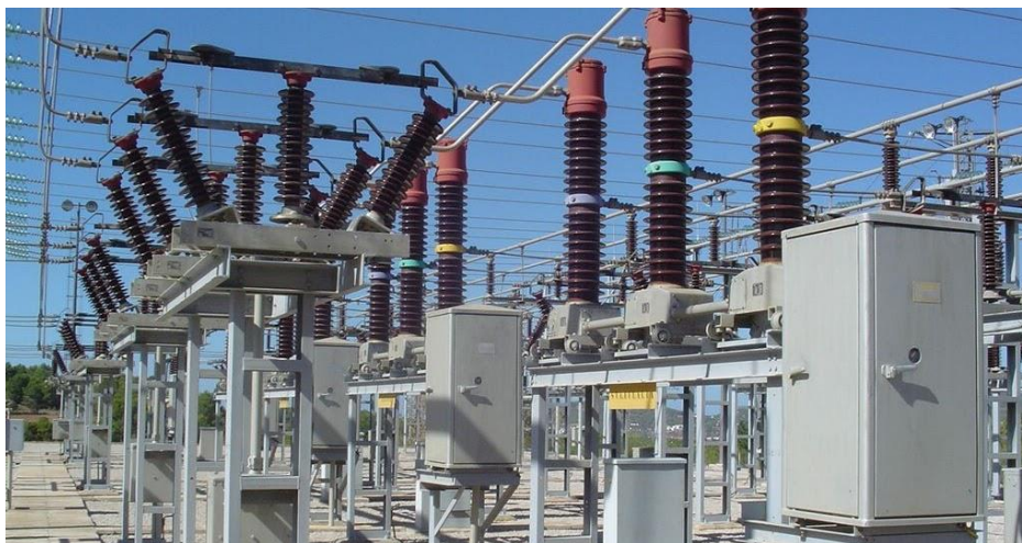
Figura 1. Interruptores y seccionadores en patio de llaves.
