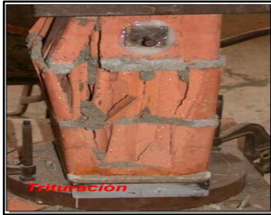
Figura 2: Falla por trituración de la pila de albañilería (50 p. 18).
