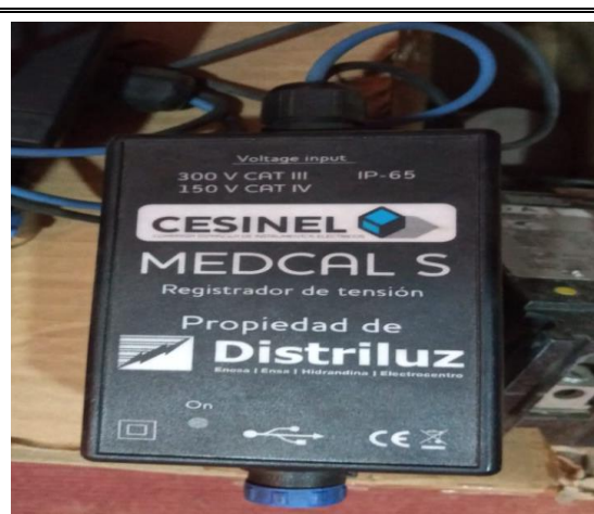
Figura 25. Analizador de red Cesinel
