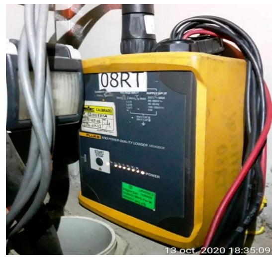
Figura 27. Analizador de red Fluke
