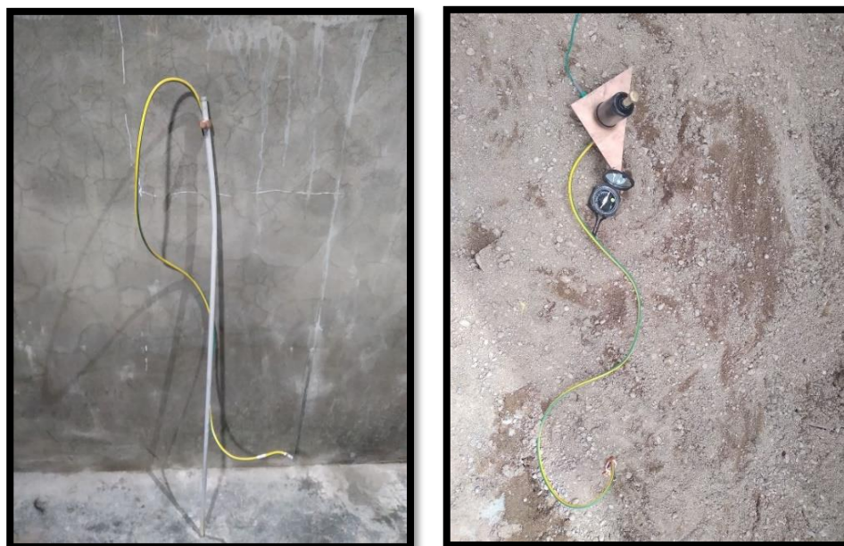
Figura 43. Implementación de la protección catódica por corriente galvánica
