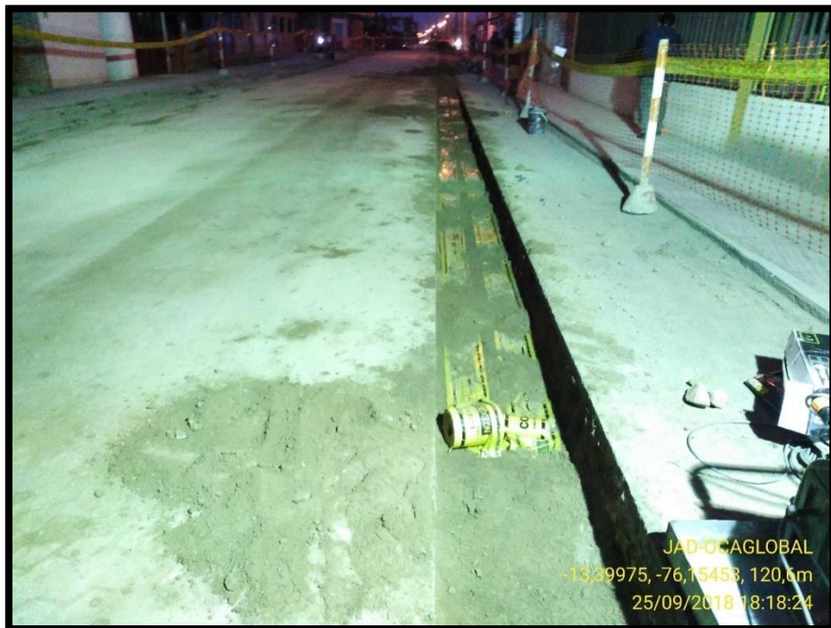
Imagen 48: Instalación de cinta de no excavar en zanja mixta Fuente: Fotografía propia
