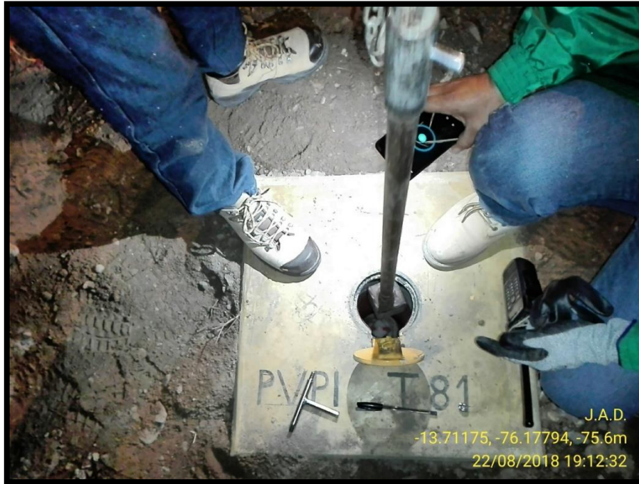
Imagen 60: Apertura de poliválvula para gasificación de una malla Fuente: Fotografía propia
