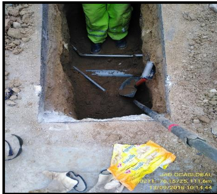
Imagen 35: Interferencias detectadas en calicata Fuente: Fotografía propia
