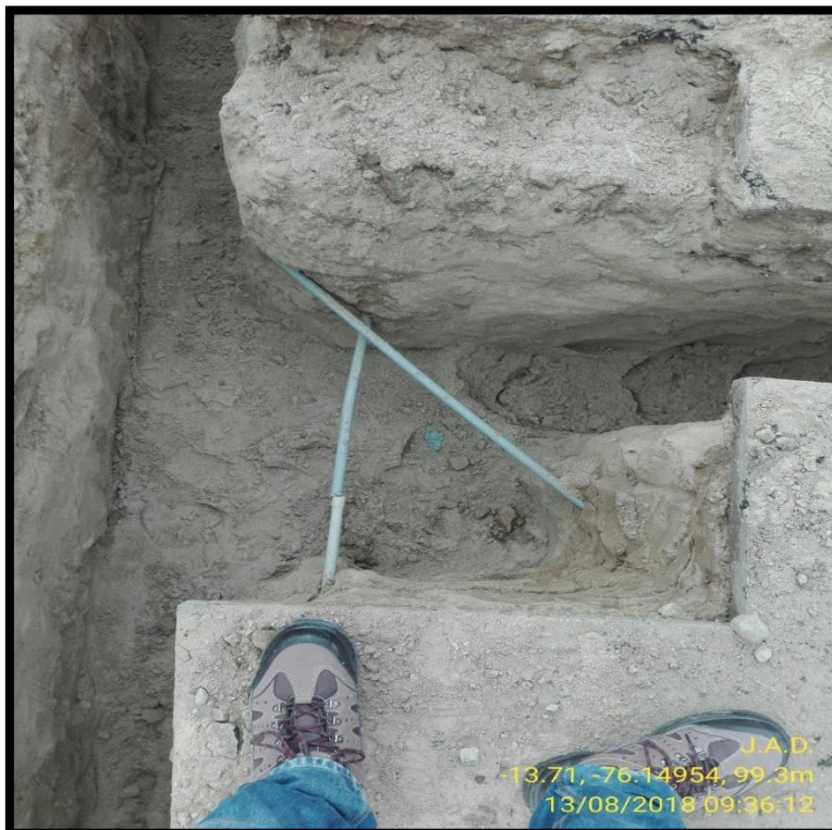
Imagen 8: Afectación de conexiones domiciliarias de agua clandestinas Fuente: Fotografía propia
