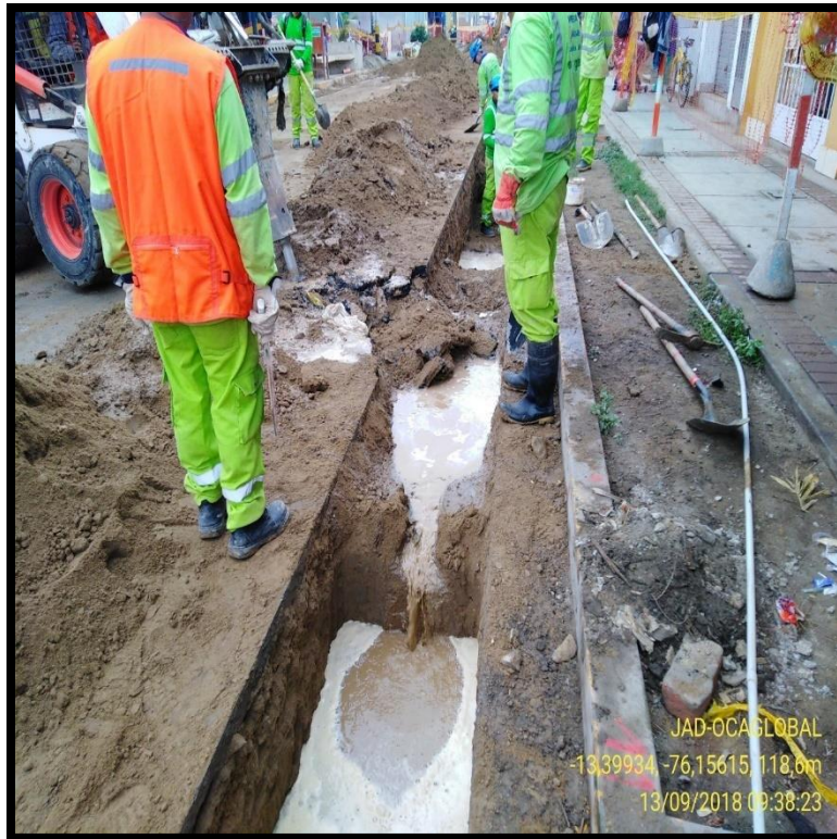
Imagen 7: Rotura de conexión domiciliaria de agua Fuente: Fotografía propia
