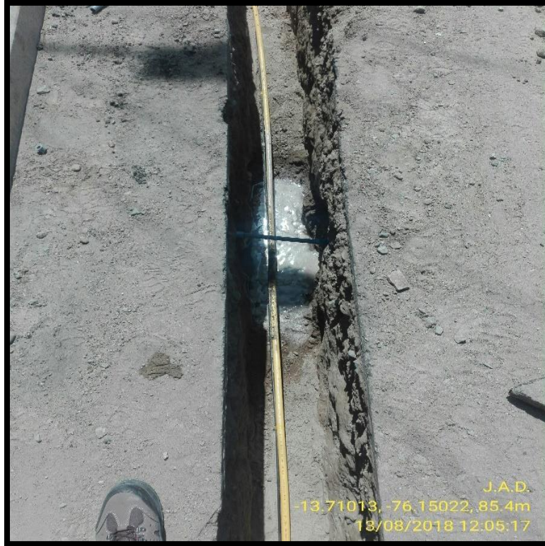
Imagen 5: Rotura de conexión domiciliar de agua Fuente: Fotografía propia
