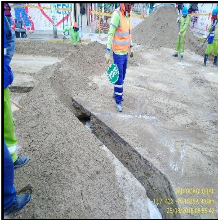
Imagen 6: Rotura de tubería matriz de agua DN 110 Fuente: Fotografía propia
