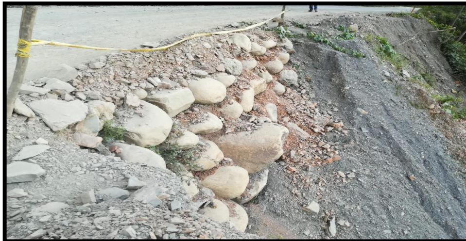
Figura 11 Falla rotacional con pérdida de banqueteta.
