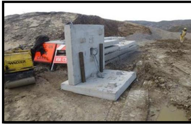
Figura 21 Se observa las Placas de Anclaje ensambladas, listas para ser transportadas a su posición final.
