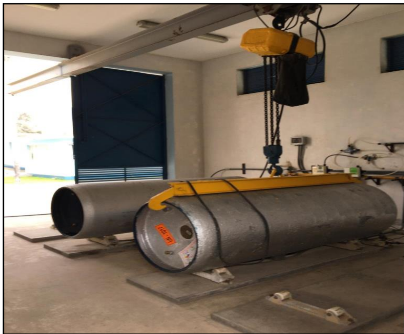
Figura 10. Zona de almacenamiento del cloro gaseoso.
