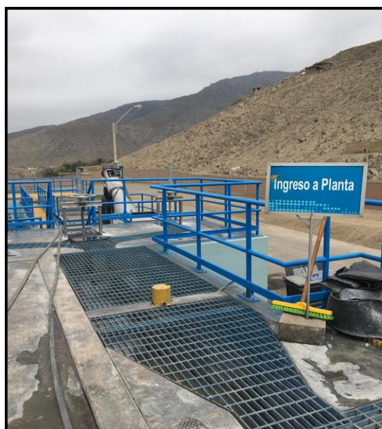
Figura 6. Inicio del tratamiento de agua - tratamiento preliminar.
