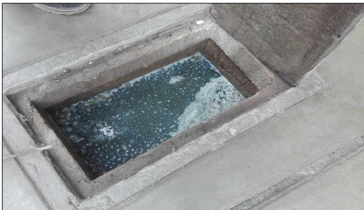
Figura 24. Caja de registro de Inversiones Ormegar.
