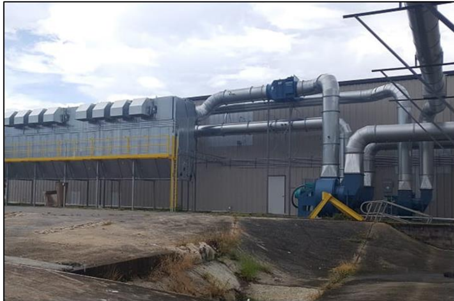
Figura 9. Sistema de ductos externo. Tomada de Alvic, que usa instalación de colector de polvo Nederman
