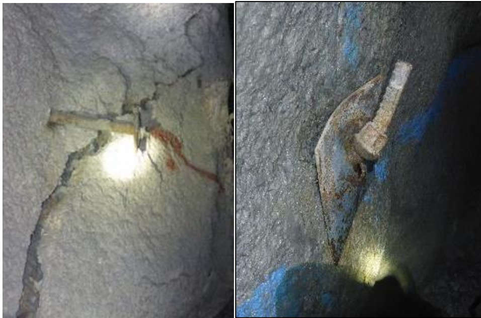
Figura 20. Fisuramiento del concreto shotcrete vía húmeda
