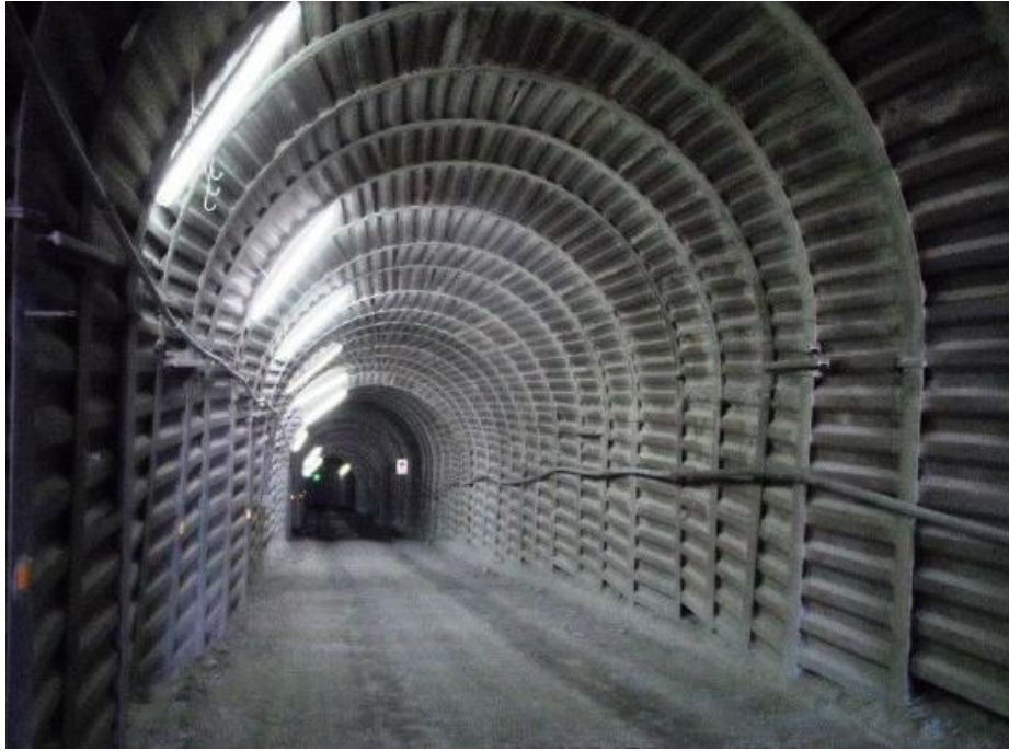
Figura 3. Sistema de cimbras para el sostenimiento de labores principales Tomada de Departamento de Geomecánica del Consorcio Minero Horizonte S. A. (8)
