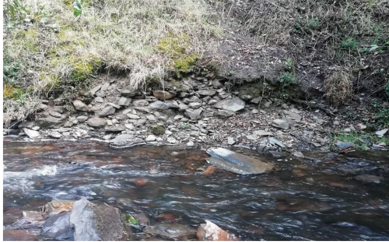
Fotografía 18. Erosión de los bordes del río.
