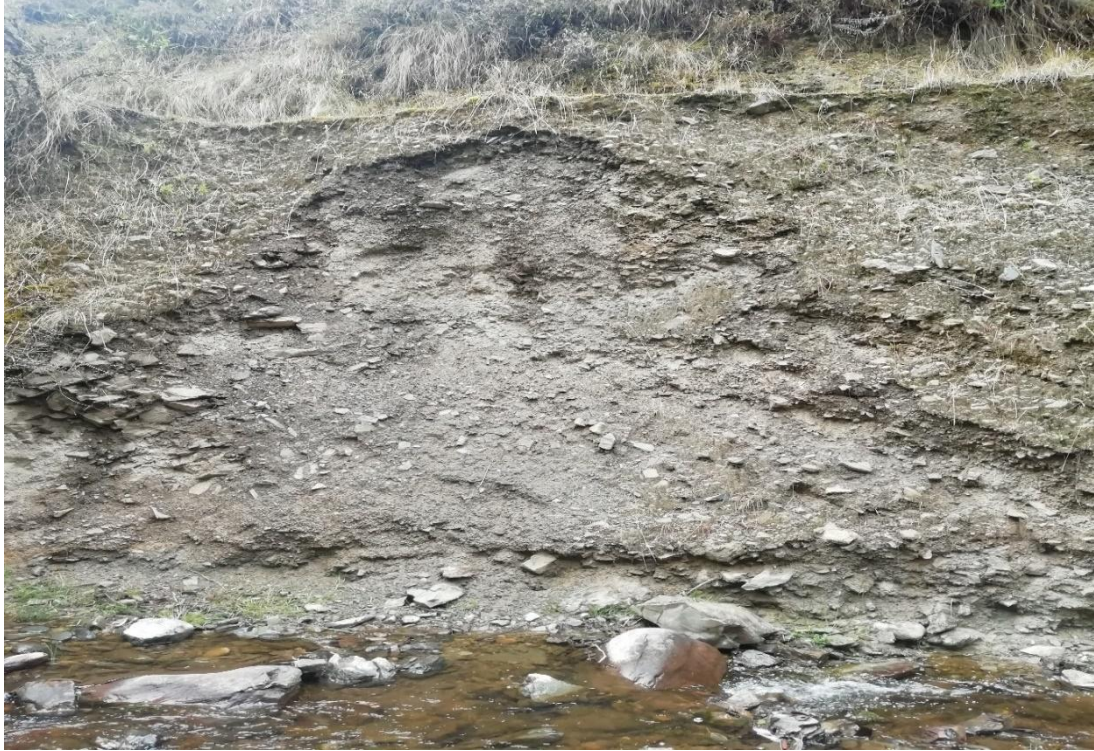
Fotografía 16. Desprendimiento de las paredes ribereñas del río.
