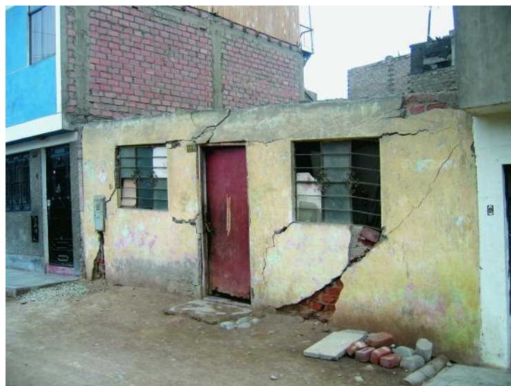
Figura 3. Casa muy dañada en el barrio 1° de Mayo (Cercado de Lima). Tomada de “El sismo del 15 de agosto de 2007 en la Margen Izquierda del Río Rímac (Lima)”, por Jérémy Robert y Robert D'Ercole, 2009, p. 519.
