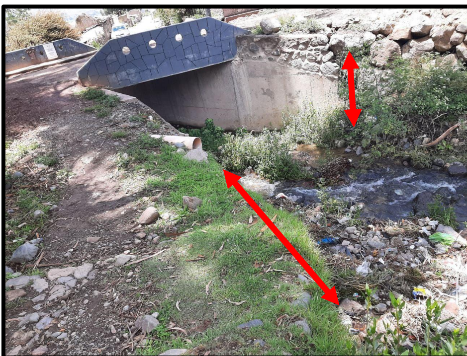
Fuente: Elaboración propia, base del puente con signos evidente de desgaste por fisuración.
