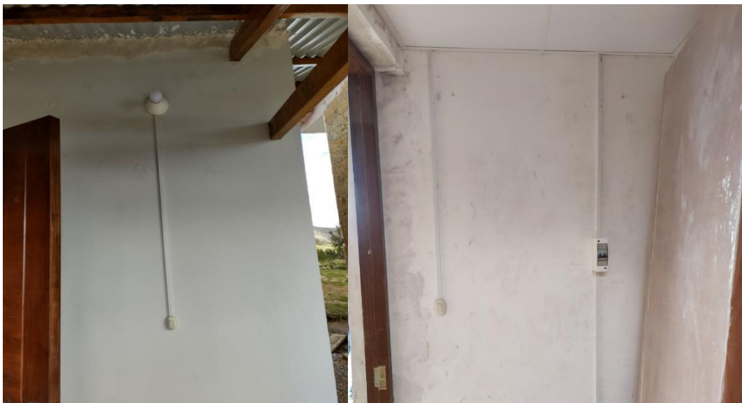
Figura 74. Iluminación exterior e interior.
