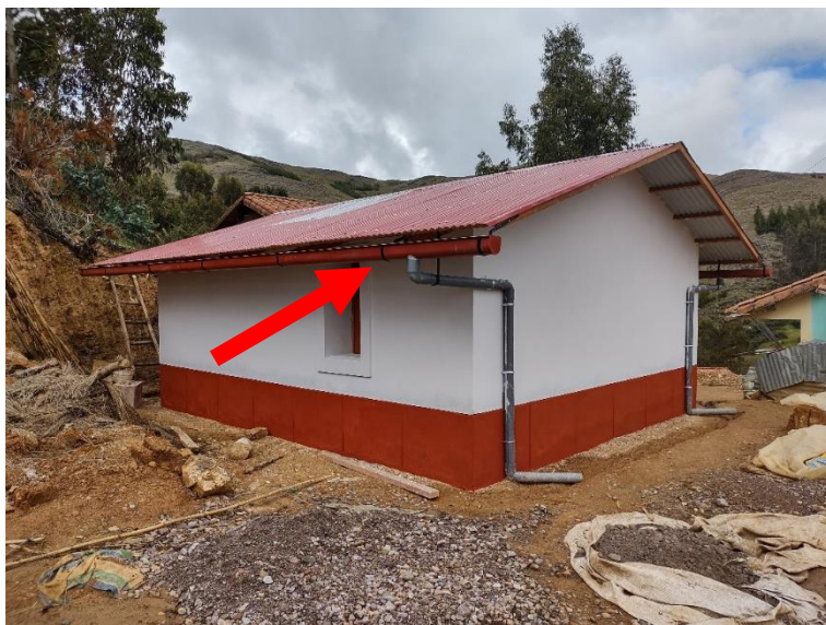
Figura 76. Montantes de evacuación pluvial.
