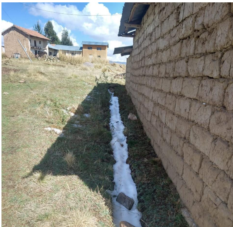
Figura 8719. Secuela de precipitaciones pluviales.
