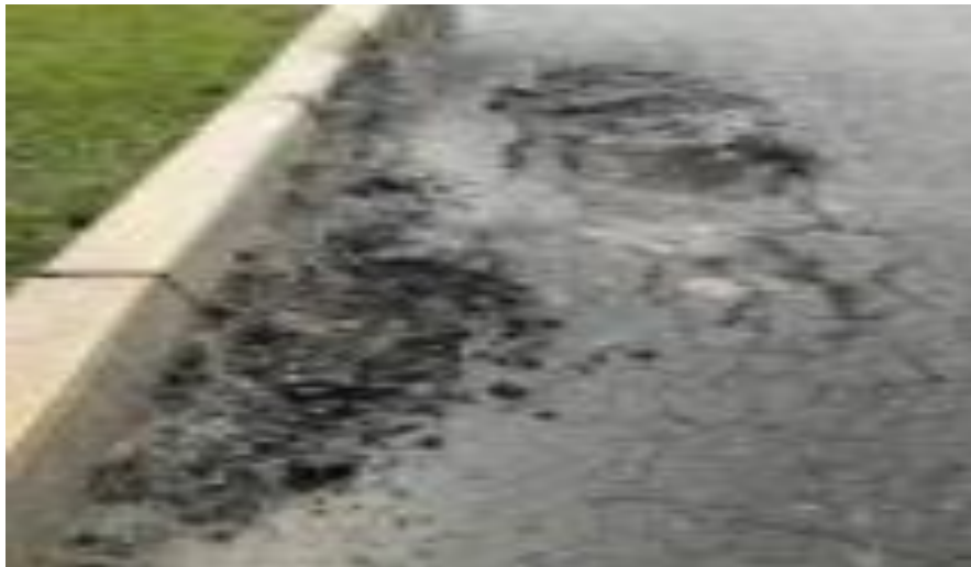
Figura 1.2 Deformación en pavimentos flexible y sub rasante
