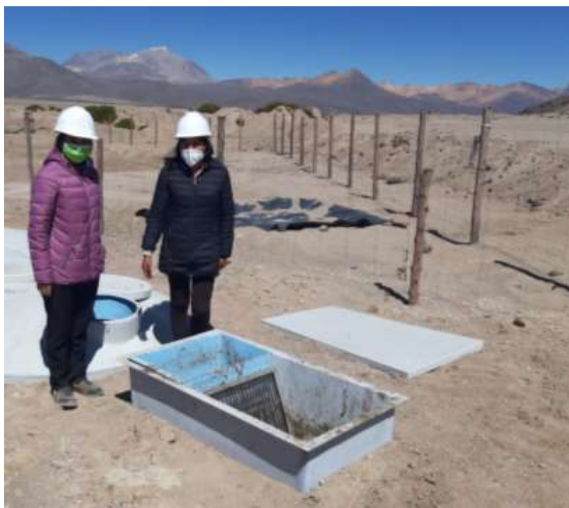
Fotografía N° 5: reja de desbaste de fibra de vidrio
