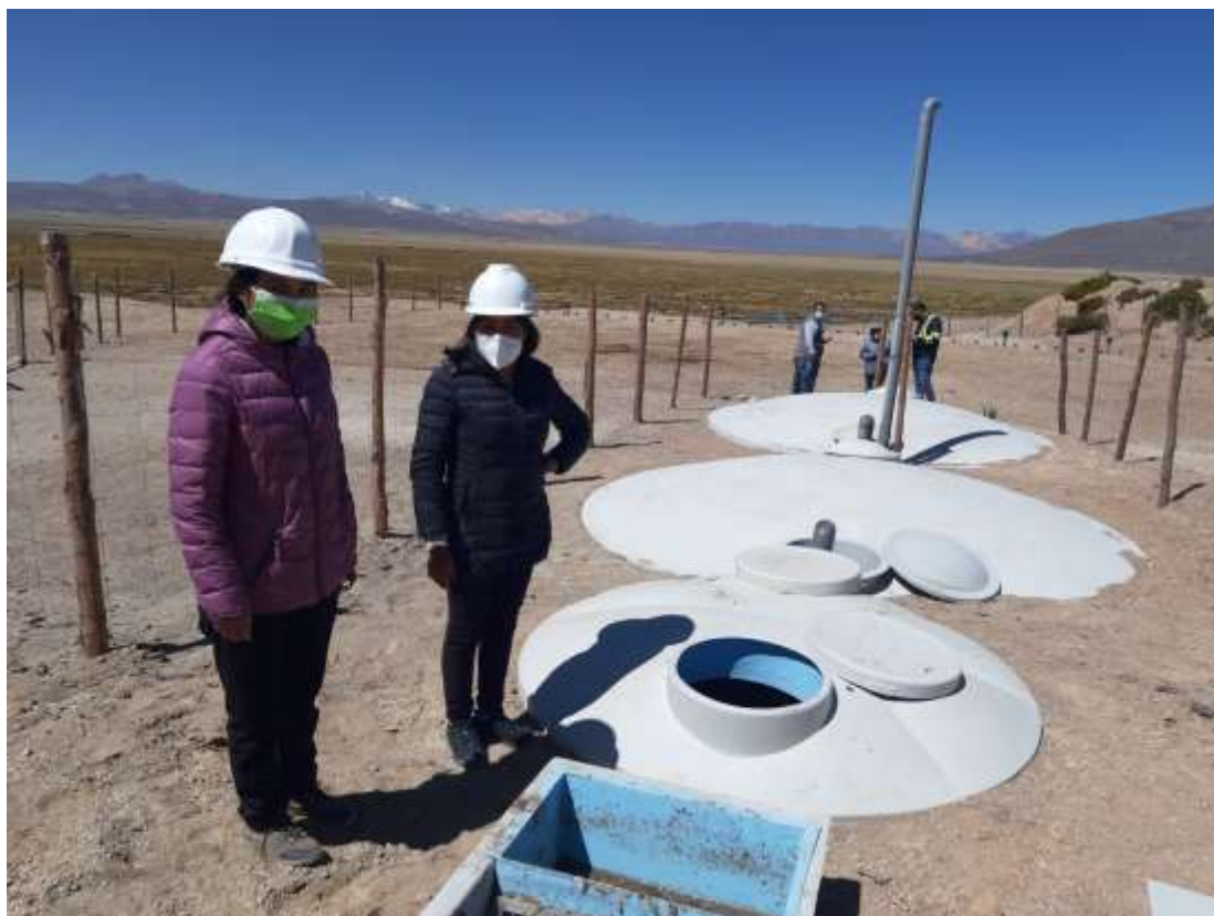
Fotografía N° 6: de izquierda a derecha Sullma Cc.; Maritza M. se observa la trampa de grasa y los dos tanques del tratamiento primario.
