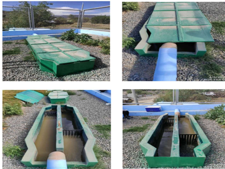
Figura 2. Instalaciones de la PTAR de Yarabamba. En la imagen se muestra la cámara de rejillas, que posterior a ello está el desarenador.
