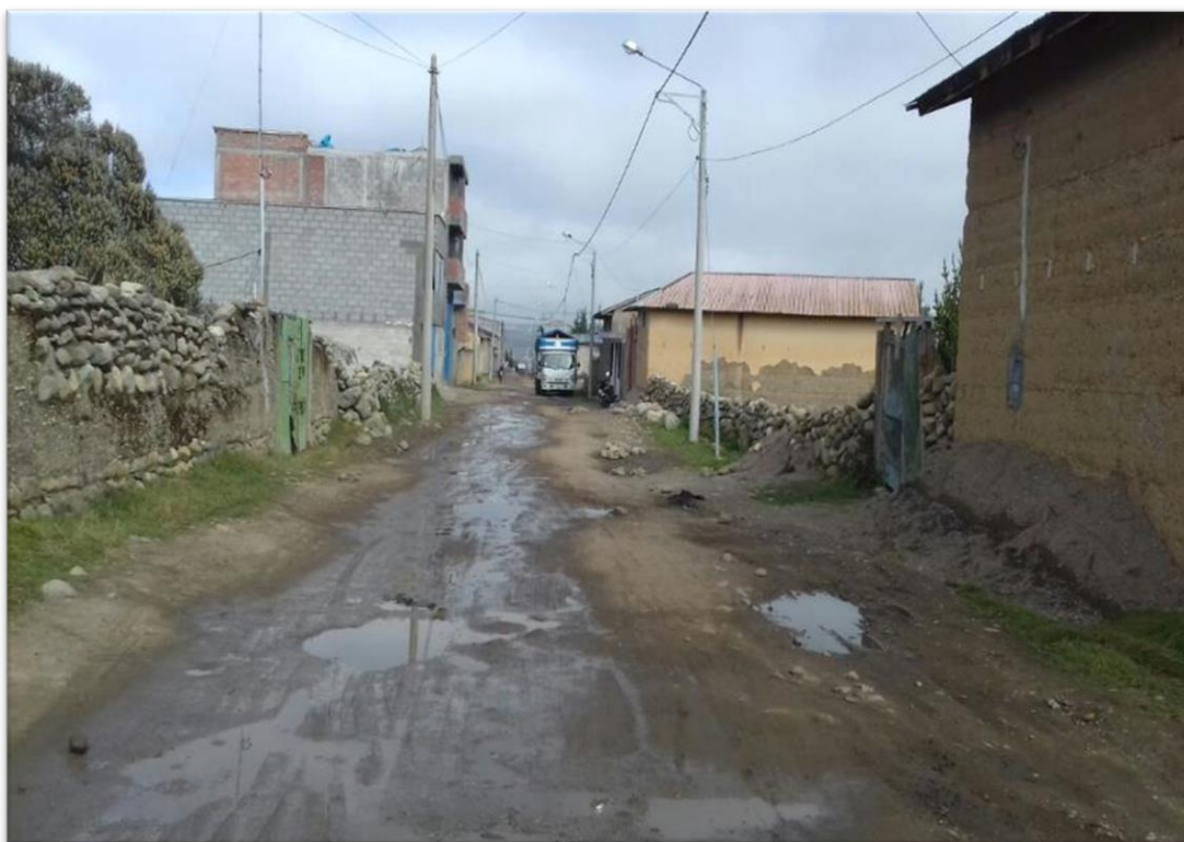
Figura 16. Jr. Alfonso Ugarte, vía deteriorada con presencia de baches
