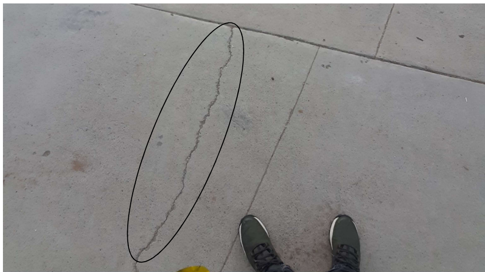
Figura 15: Fallas por fisuramiento en la losa de concreto. Fuente: (Elaboración propia).
