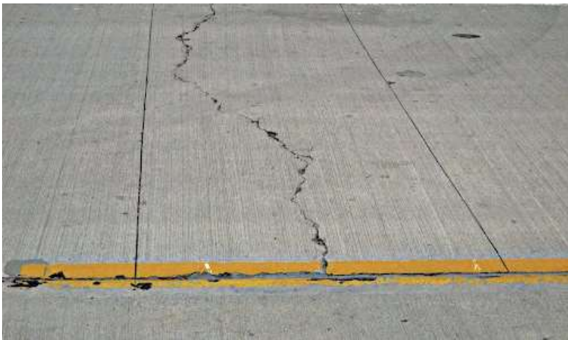
Figura 1: Junta aserrada y fisuras del pavimento.
