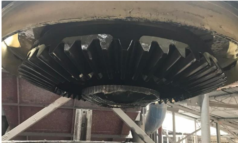
Figura 37. Desmontaje de la excéntrica fracturada con todo el contrapeso
