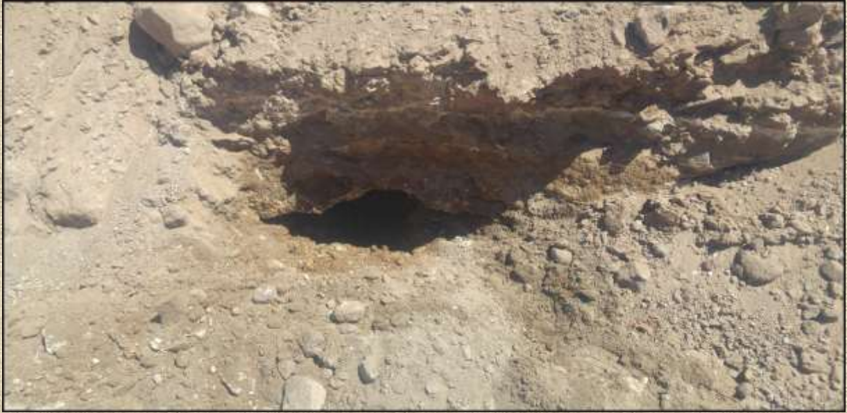
Figura 101. Identificación de tubificación retrógrada que atraviesa la plataforma - 02
