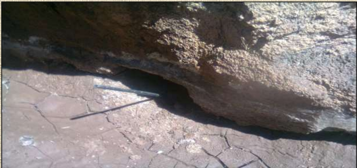
Figura 100. Identificación de tubificación retrógrada que atraviesa la plataforma - 01
