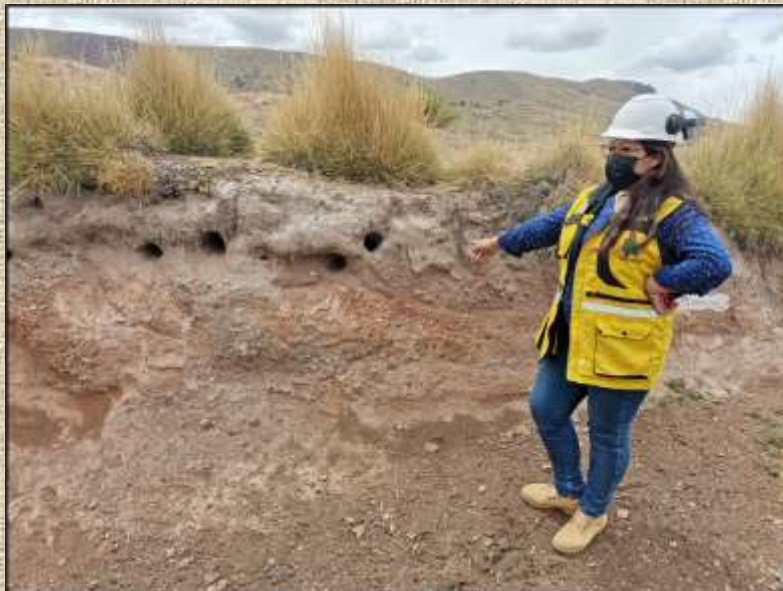
Figura 102. Identificación de erosión interna en puntos cercanos a la carretera
