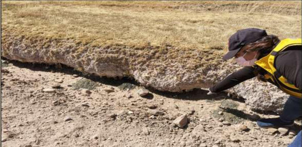
Figura 107. Se evidencia erosión interna en el talud de la carretera
