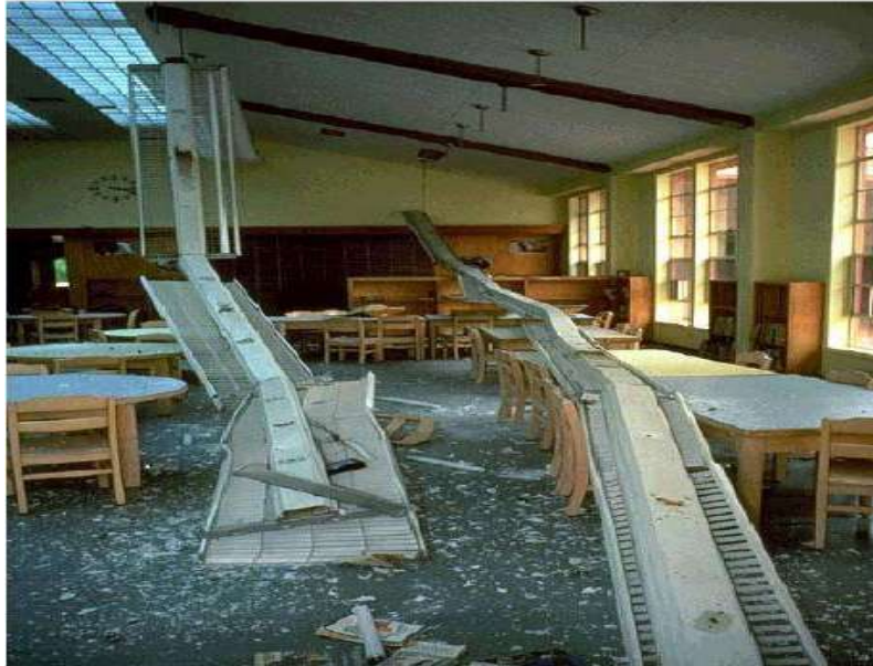
Figura 14. Caída de lámparas de iluminación en colegios.
