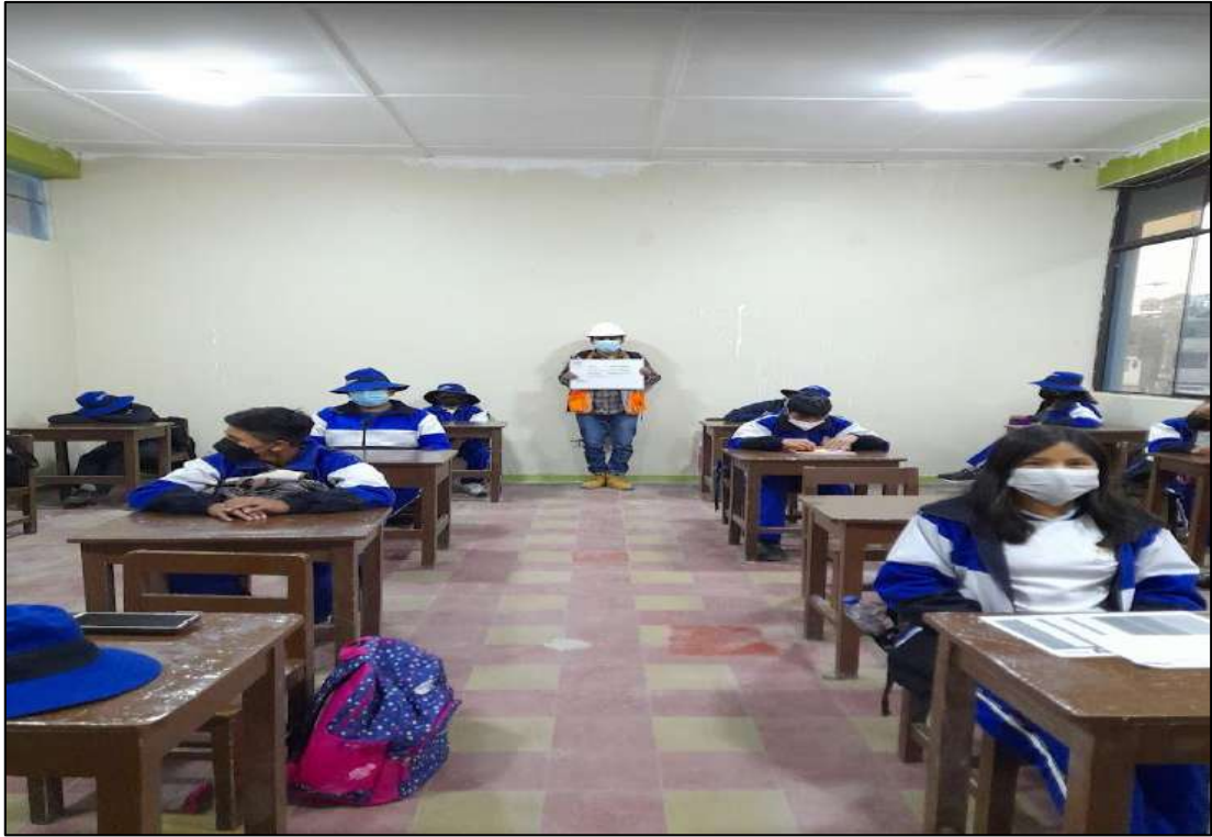
Figura 174: Servicio de energía eléctrica en la Institución Educativa Jorge Basadre Fuente: Elaboración Propia
