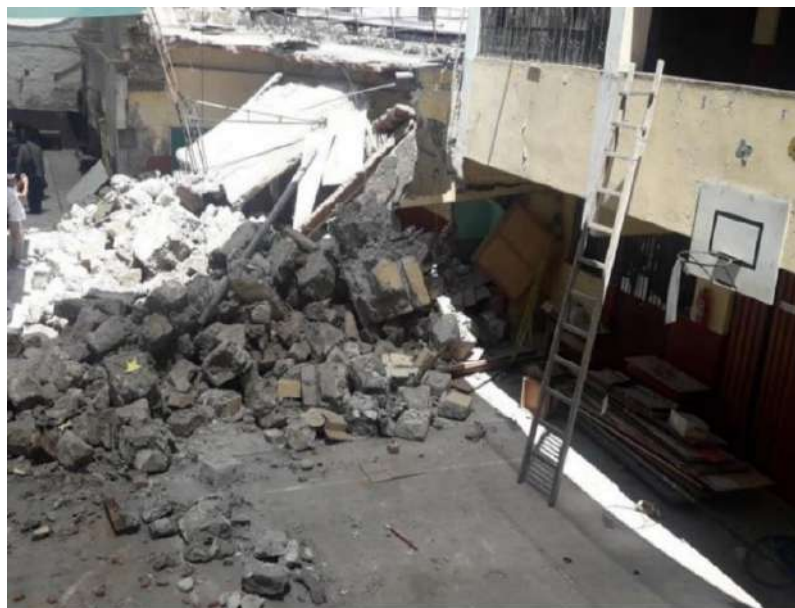
Figura 11. Institución Educativa “República de Venezuela” al borde del colapso.
