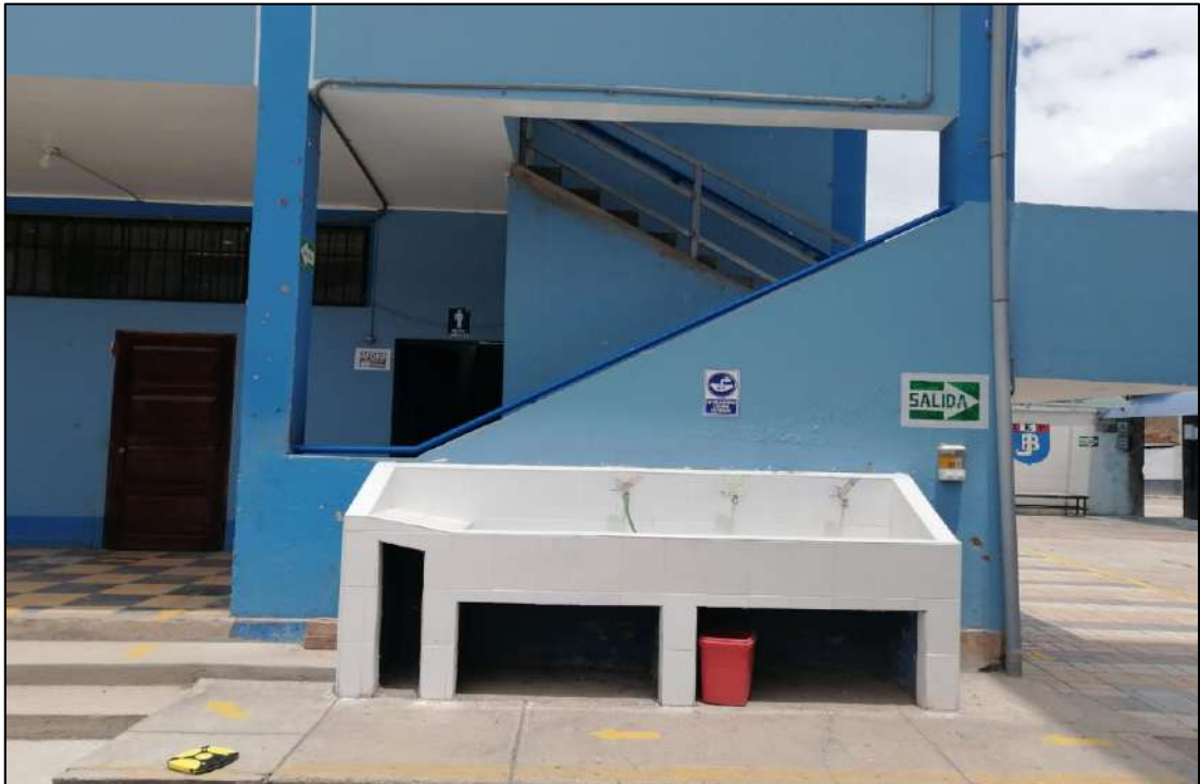
Figura 175: Servicio de agua potable en la Institución Educativa Jorge Basadre Fuente: Elaboración Propia
