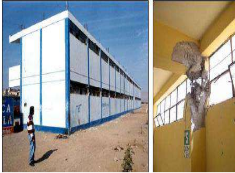
Figura 12. Problemas de columna corta en edificación escolar, Tacna, Perú - 2001.
