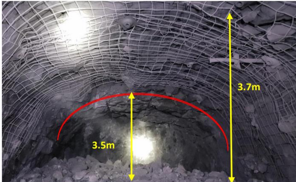
Figura 33. Control de la sobre rotura y estabilidad de corona SN 6917
