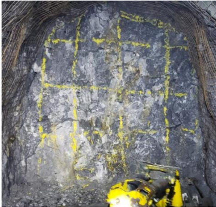
Figura 20. Marcado de malla con colas SN 6917
