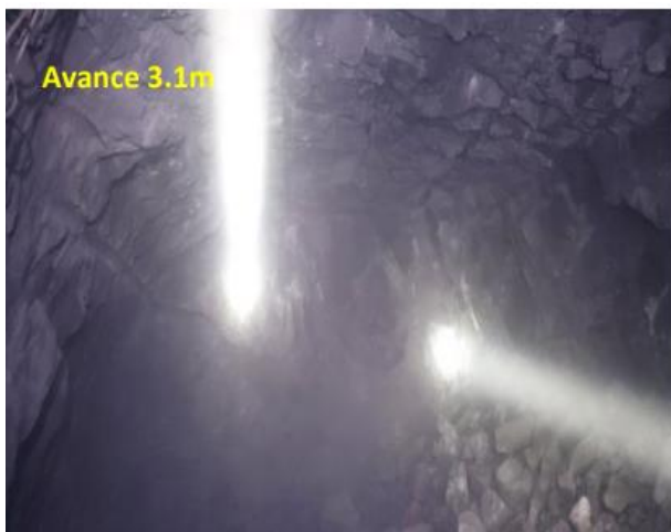
Figura 34. CX 1169 voladura 5 taladros carga con 4 taladros de alivio 85 % cañas
