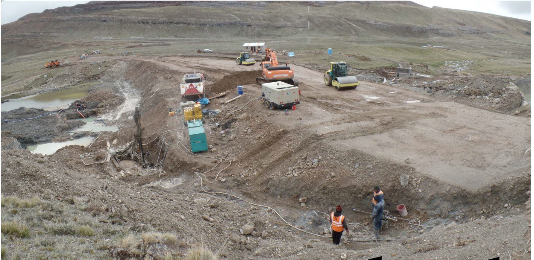
Fotografía N.º 2. Vista panorámica de la Presa 1 de progresiva 0+000 a 0+110. Nótese que la central de inyección esta ubicada en progresiva 0+046.
