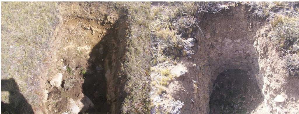
Fotografía N.º 13. Calicatas en lado izquierdo y derecho del eje de presa.
