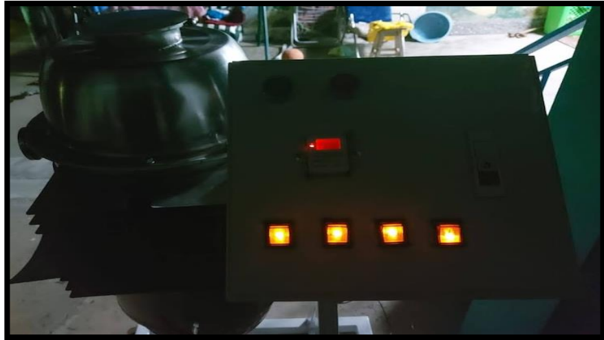
Figura 40. Funcionamiento del tablero de control
