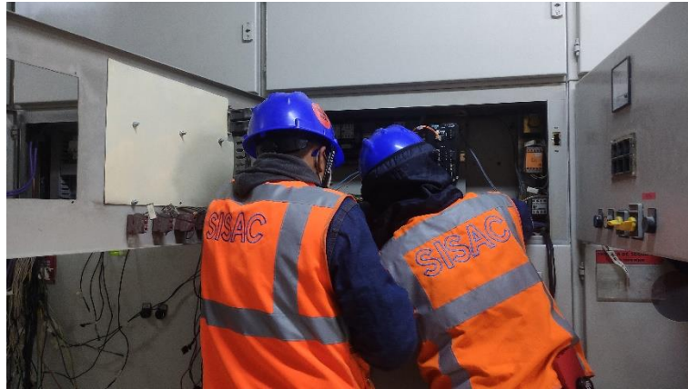
Figura 27. Desconectado y desmontaje de las placas existentes en la celda de MT
