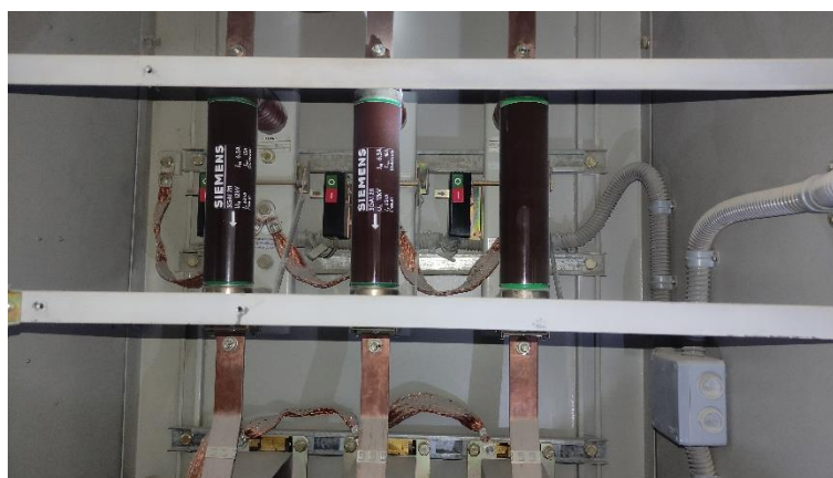
Figura 34. Prueba de funcionamiento y señales de fusibles
