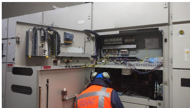
Figura 38. Conexionado de los conductores de la trituradora TANDEN
