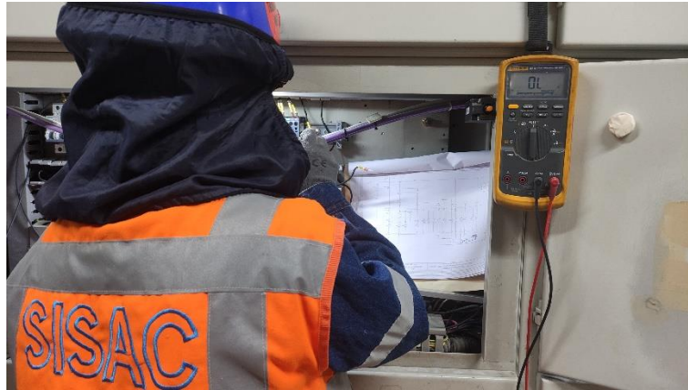
Figura 26. Timbrado y amarillado de circuito
